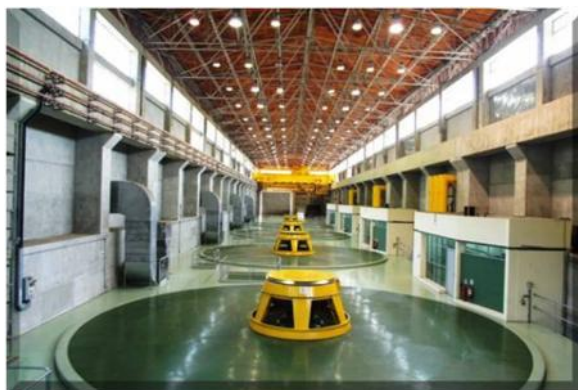
Ilustración 8 Casa de máquinas.
