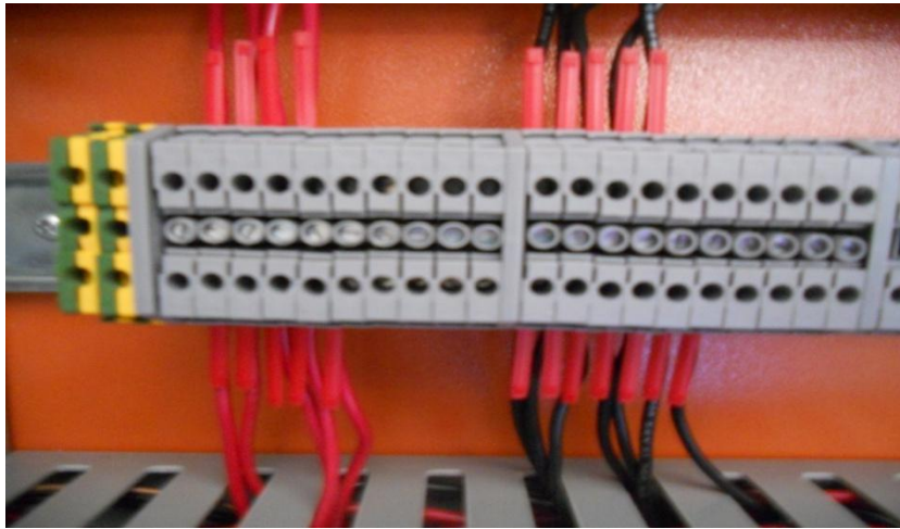
Figura 37. Conjunto de borneras de polarización. 8
