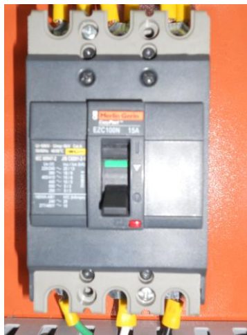
Figura 21. Interruptor termomagnético totalizador. 8
