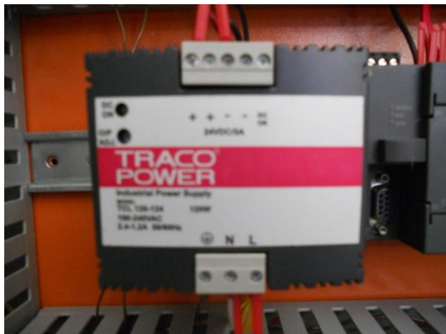
Figura 25. Fuente de alimentación Traco Power TCL 120-124 24VDC. 8
