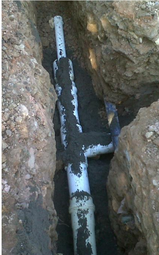
Figura 18. Fotografía Instalación de Tee 4x4 + reducción de 4 a 2 para empalme y relleno con arena.
