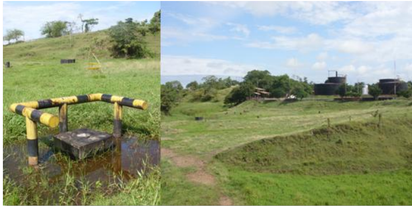
Ilustración 16. Pozo de monitoreo – Predio aledaño, Bajo2.
