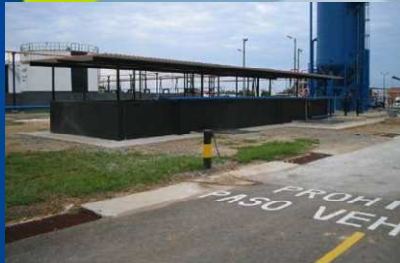
DECANTADOR UBICADO EN ESTACION SURIA SUPERINTENDENCIA DE OPERACIONES APIAY – ECOPETROL S.A.
