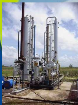
TORRE DE GLYCOL ESTACIÓN TOCARÍA EMPRESA PERENCO LLANOS ORIENTALES
