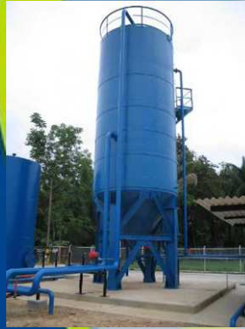
DECANTADOR UBICADO EN ESTACION SURIA SUPERINTENDENCIA DE OPERACIONES APIAY – ECOPETROL S.A.
