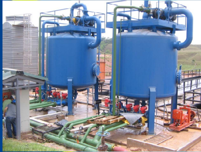
FILTROS AUTOMATICOS CAPACIDAD 30.000 BWPD CAMPO RUBIALES DE LA COMPAÑIA METAPETROLEUM LIMITED
