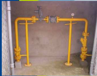
ESTACION DE REGULACION Y MEDICION PARA EL CORREGIMIENTO DE PASO CUSIANA, MUNICIPIO DE TAURAMENA
