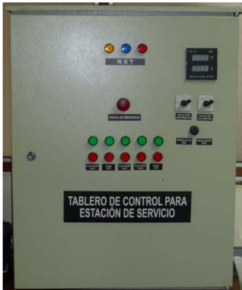
Figura 40. Tablero de control para Estación de Servicio. Vista frontal. [10]
