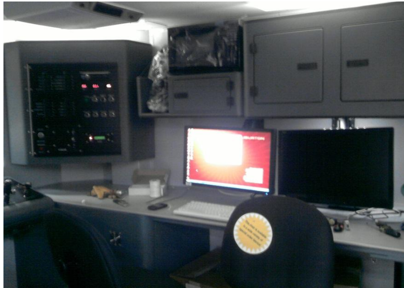
Figura. 71, Cabina Unidad de Registro
