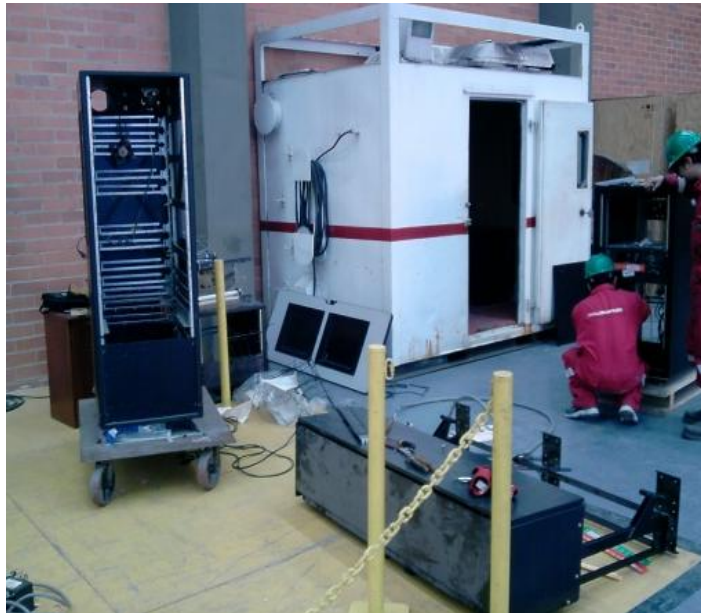
Figura. 31, Unidad de chequeo pre operacional base Funza.
