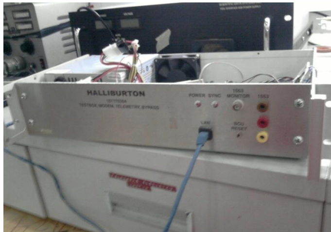
Figura. 68, D4MP, Panel de laboratorio sin cobertura.
