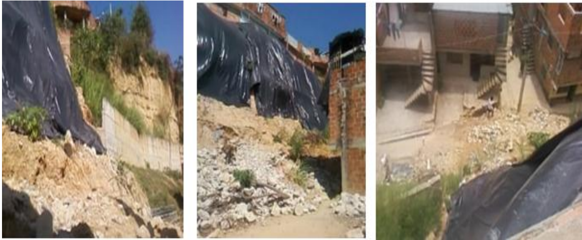
Fotografía 4 Fenómenos remoción en masa perfil k+010
