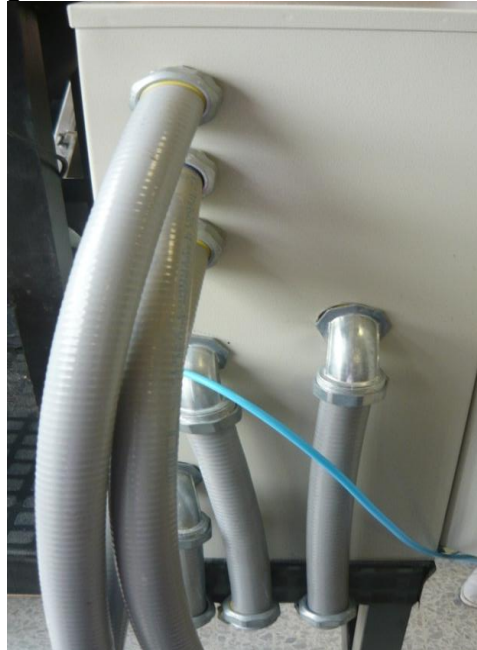
Figura 95. Conexión entre los gabinetes Fuente autores
