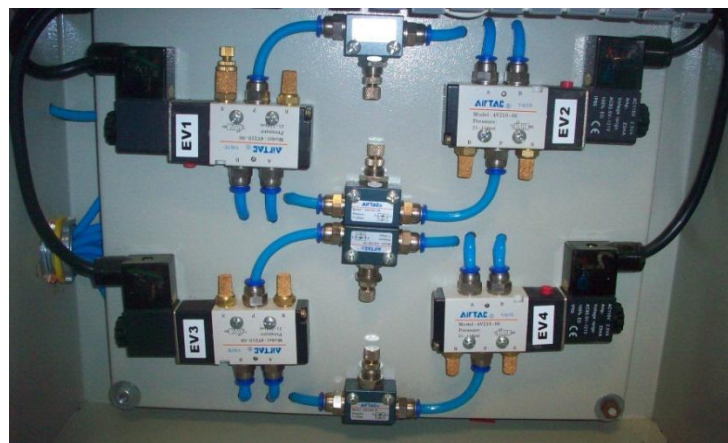
Figura 86. Distribución de electroválvulas Fuente autores
