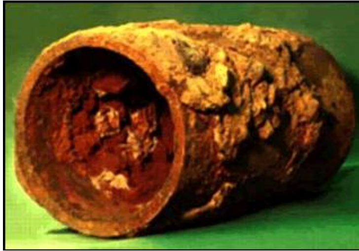
Figura 2. Efectos de la corrosión en la industria petrolera [5]
