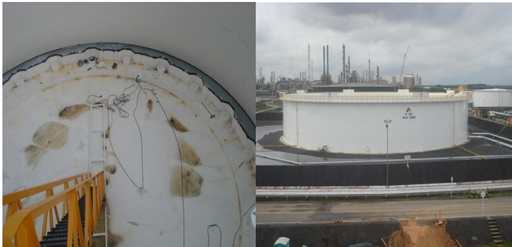
Foto 9. Tanque Techo Flotante
