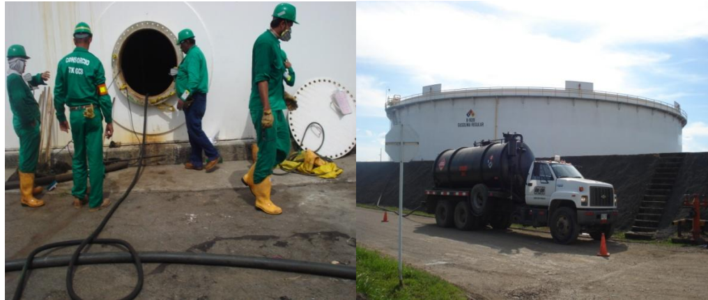
Foto 11. Retiro de Lodos con Camión de Vacío
