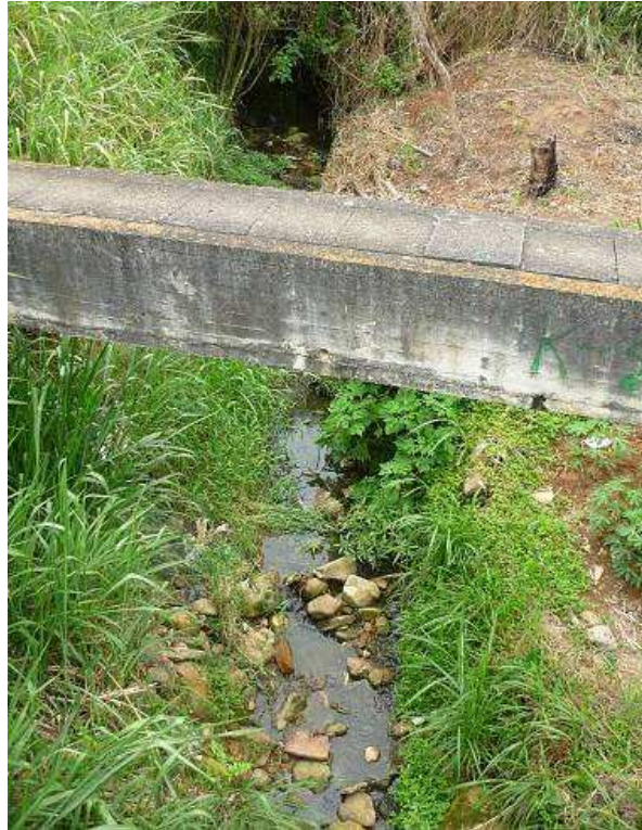
FIGURA 5. Corriente de Agua contaminada
