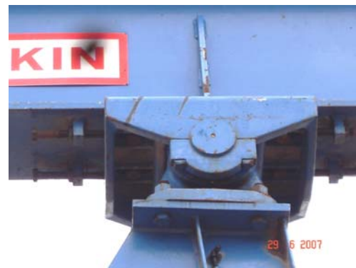
Imagen 30. Cojinete averiado. Copyright Metalizadora del Oriente. Ltda.
