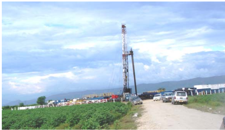
Imagen 22. Pozo Abanico 21. Copyright Metalizadora del Oriente. Ltda.
