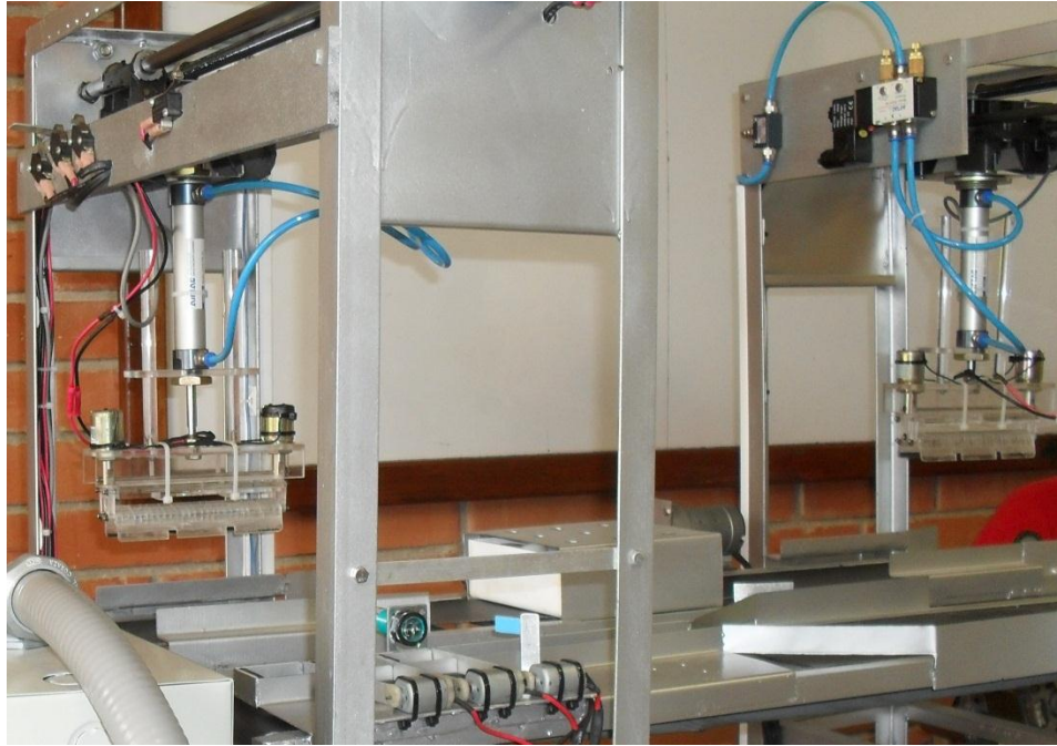
Figura33. Elementos Neumáticos Ubicados en los Puentes de la Máquina. [4]
