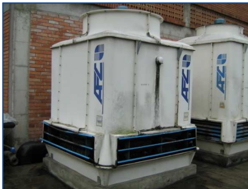
Figura 8. Torre de Enfriamiento
