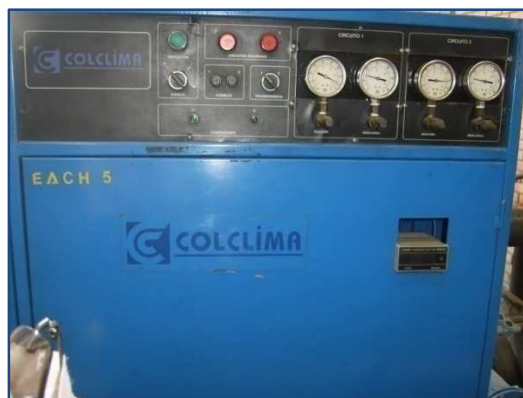
Figura 5. Tablero de fuerza y control
