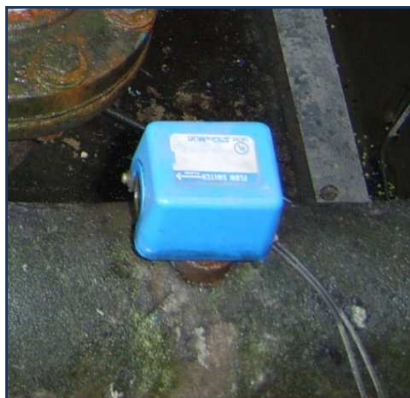
Figura 19. Conmutador de flujo – línea de circulación
