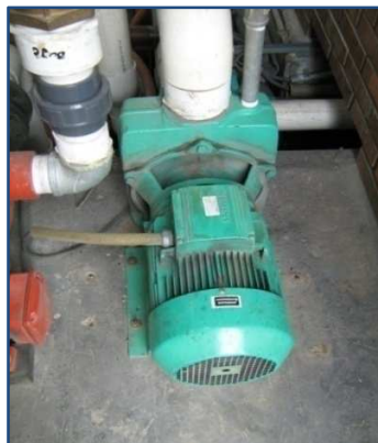
Figura 6. Motobomba de Condensación
