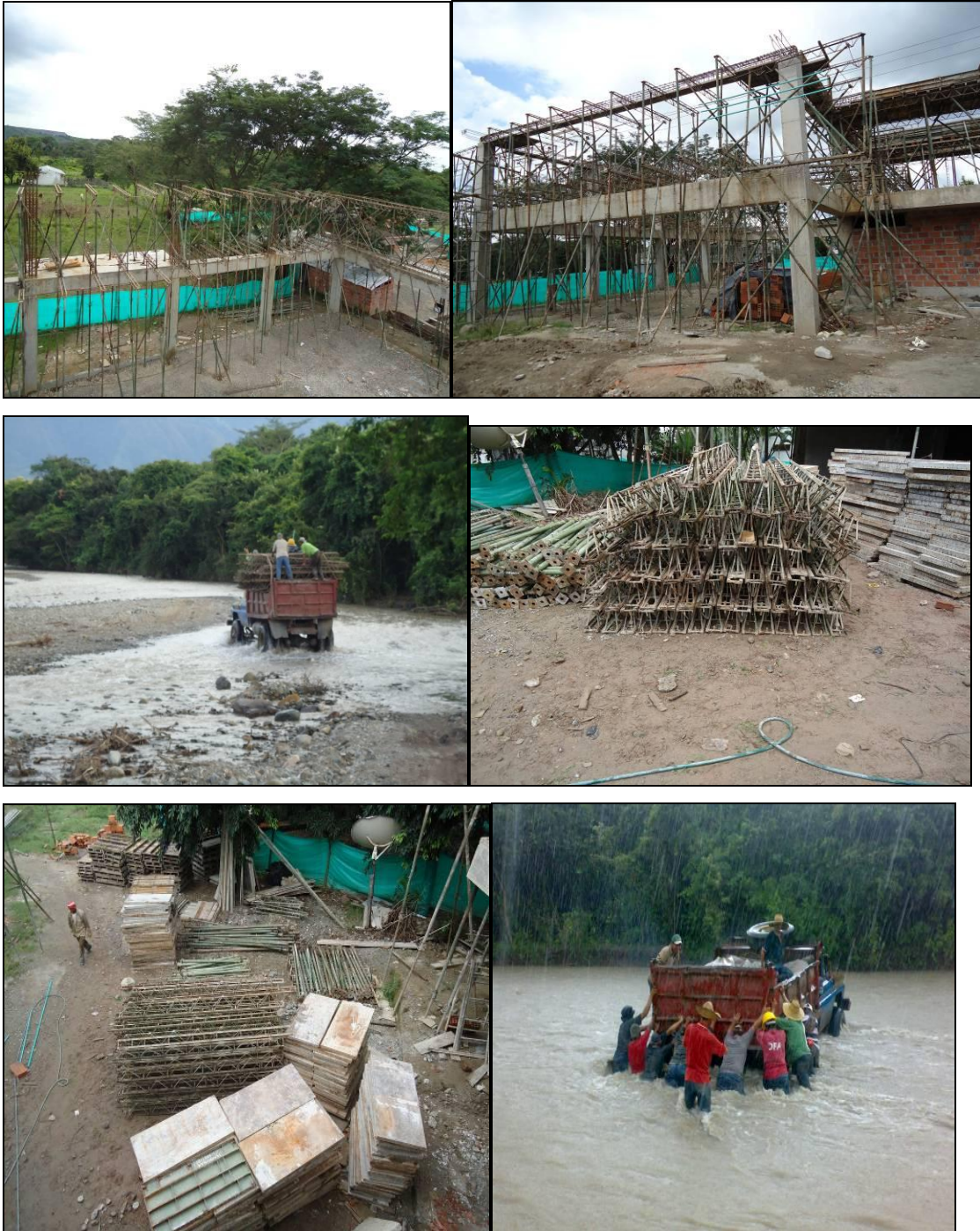
Foto. 21. Inconvenientes para la entrega de equipo por caída del puente que lleva a la Vitoria
