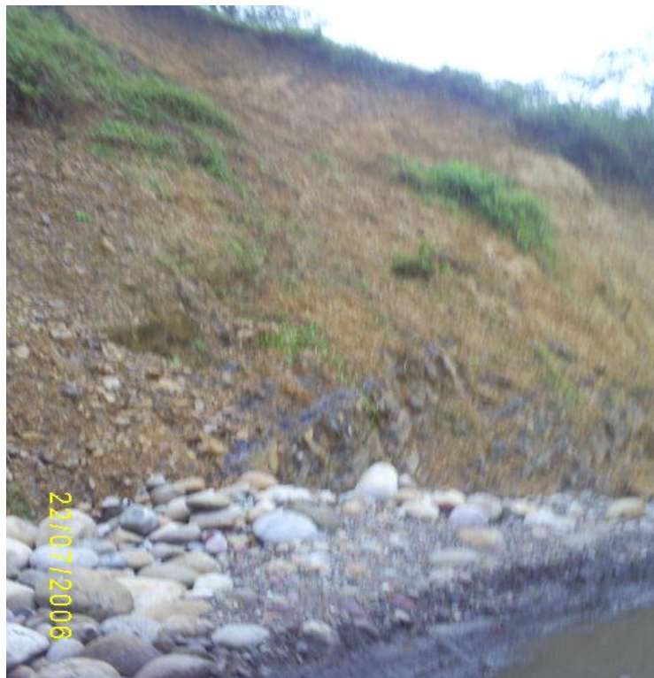
Foto. 20. Derrumbes constantes en la vía de acceso a Encino
