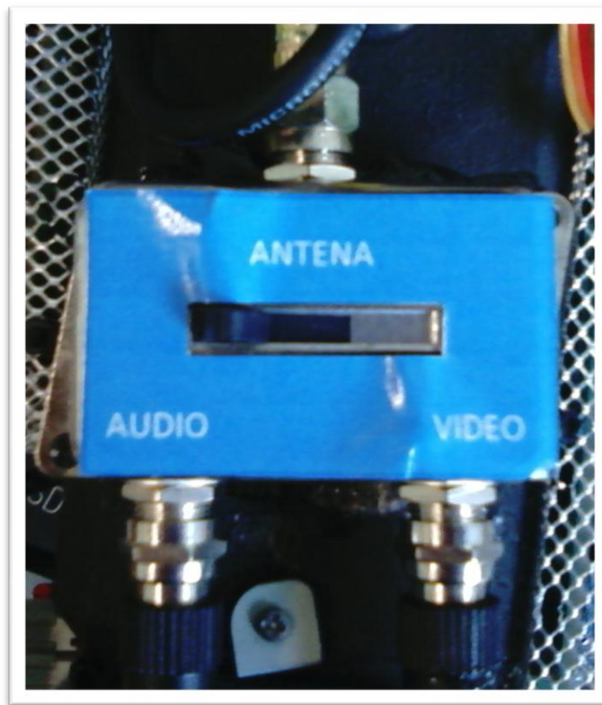
Figura 102. Selector de antena con interruptor dispuesto en audio. Fuente: Autor del texto.
