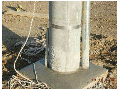
Figura 44. Bajante de puesta a tierra en líneas eléctricas 47
