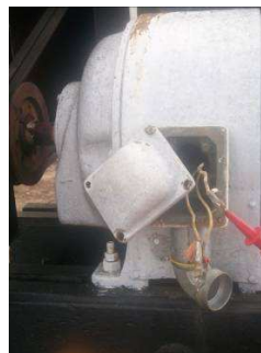
Figura 139. Medición de continuidad entre devanados 142
