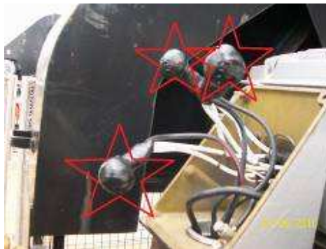
Figura 131. Acoples en cables 134
