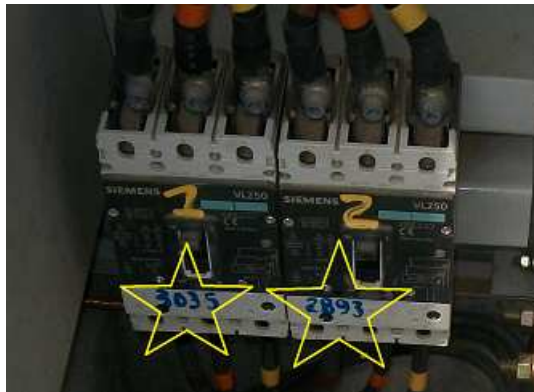
Figura 163. Identificación de totalizadores 166
