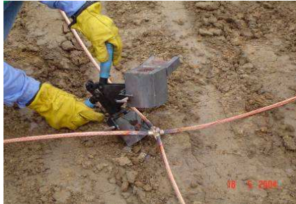
Figura 35. Uniones en conductores 38
