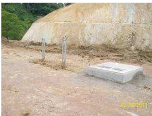
Figura 100. Base en concreto del transformador 103
