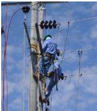
Figura 202. Posicionamiento en poste 205
