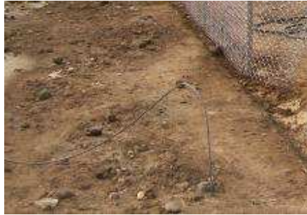
Figura 152. Conexión del telurómetro a cola de malla 155
