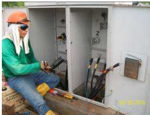
Figura 124. Prueba de aislamiento de cables 127
