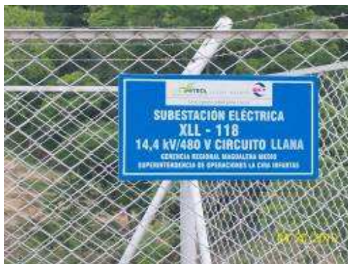
Figura 160. Identificación de Subestación 163
