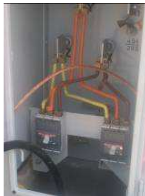
Figura 83. Conexión en transformador 86
