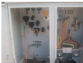
Figura 107. Prueba de aislamiento entre alta y baja tensión 110
