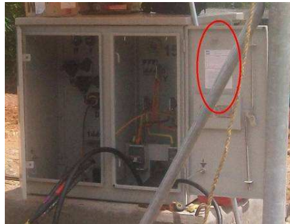
Figura 104. Placa de características del transformador 107
