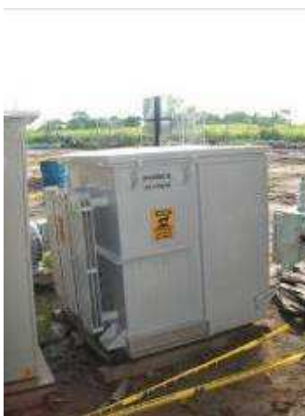
Figura 98. Transformador en bodegas 101
