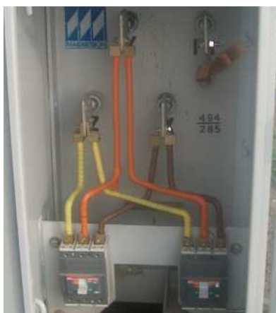
Figura 161. Verificación de conexiones en transformador 164
