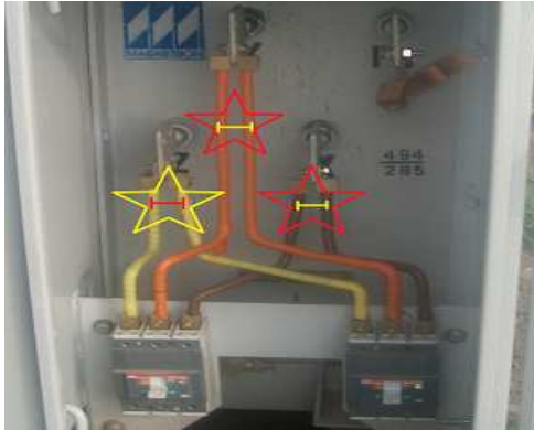
Figura 162. Verificación de distancia entre fases 165
