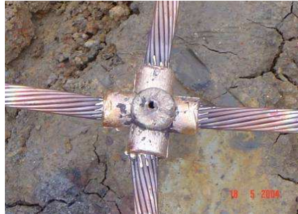
Figura 36. Soldadura con escoriación 39
