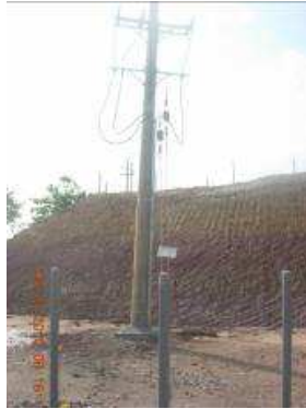
Figura 166. Verificación del cable seco 169
