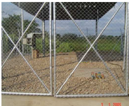
Figura 93. Portón de subestación 96
