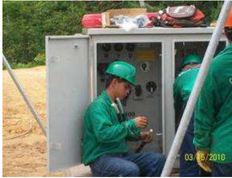
Figura 103. Conexión del transformador 106
