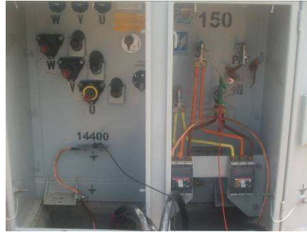
Figura 109. Prueba de aislamiento entre baja tensión y tierra 112
