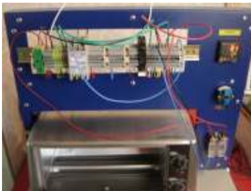
Figura19. Modulo control temperatura cableado [7]
