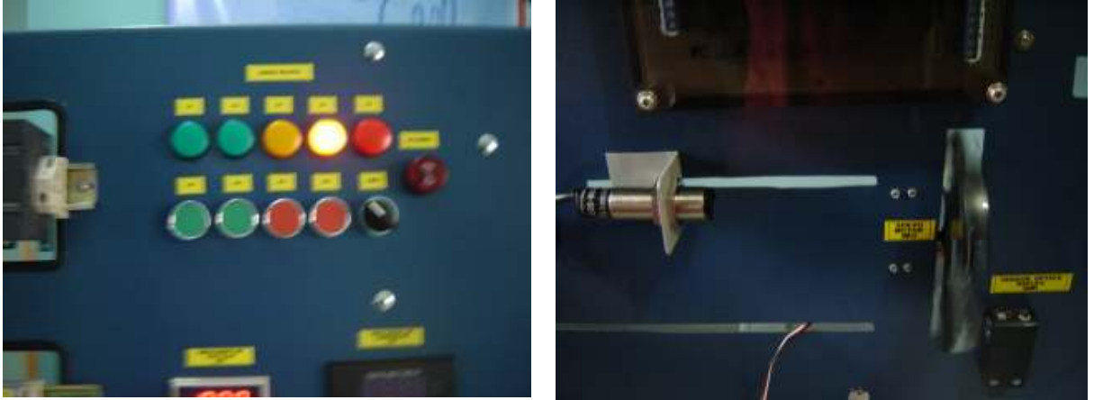
Figura 15. Prueba pulsadores luces piloto sensores fotoeléctricos [7]
