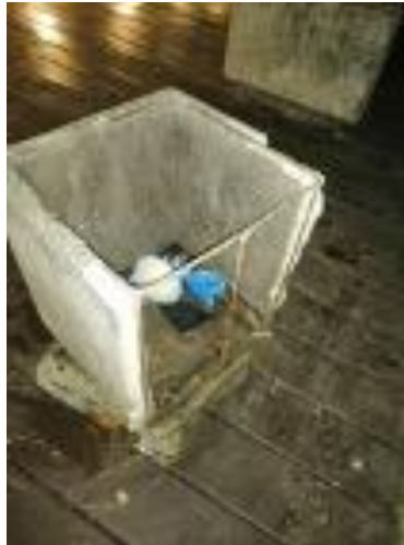
Imagen 9. Caneca de concreto en deterioro con residuos sólidos en la UVA de la Armonía, 2022. Autoría propia
