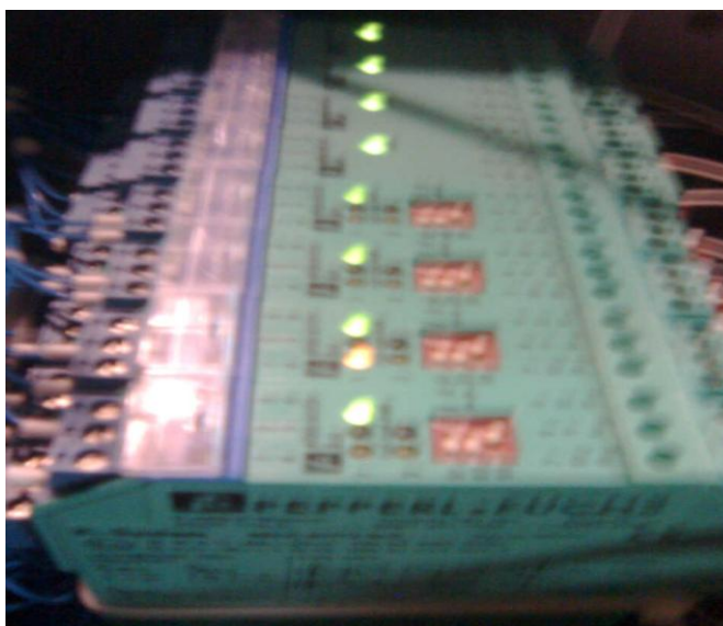
FIGURA 47. TABLERO DE LA BARRIER BOX
