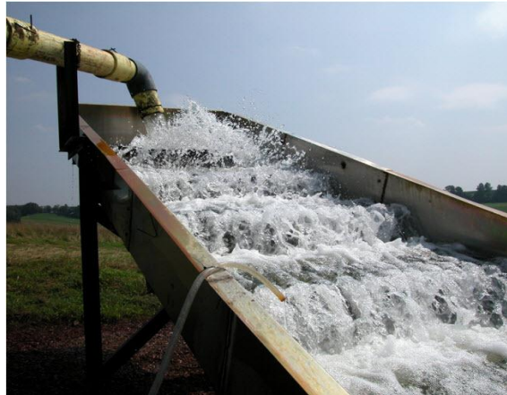
Imagen 19. Aireación del DAM por gravedad
