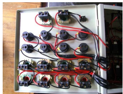
Figura 30. Parte posterior de los pulsadores y de las luces piloto. Fuente: Autor
