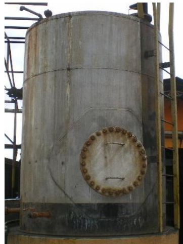
Figura 49. Tanque de abastecimiento de agua para las calderas. Fuente: Autor
