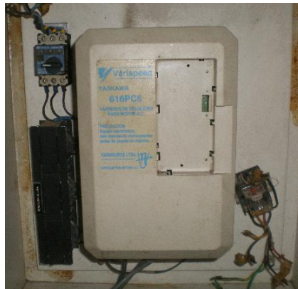
Figura 60. Variador de velocidad 440V AC a 25HP. Fuente: Autor
