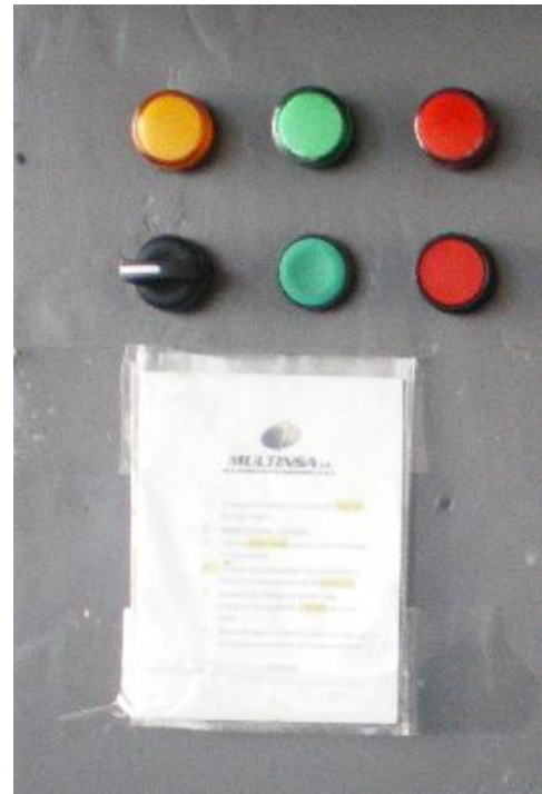
Figura 42. Procedimiento y accionamientos para el encendido y apagado del controlador. Fuente: Autor
