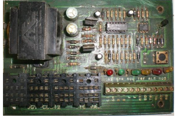
Figura 47. Antiguo control electrónico. Fuente: Autor
