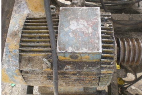
Figura 54. Motor de 50 HP del mezclador. Fuente: Autor
