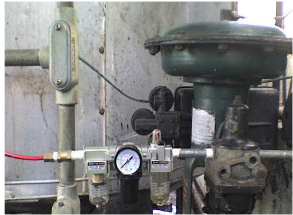
Figura 45. Filtro regulador y válvula. Fuente: Autor
