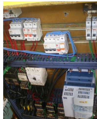
Figura 59. Tablero de control eléctrico. Fuente: Autor
