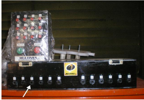
Figura 13. Controlador para el llenado de Biovarsol 1A. Fuente: Autor
