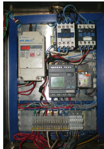
Figura 19. Control de máquina tapadora. Fuente: Autor
