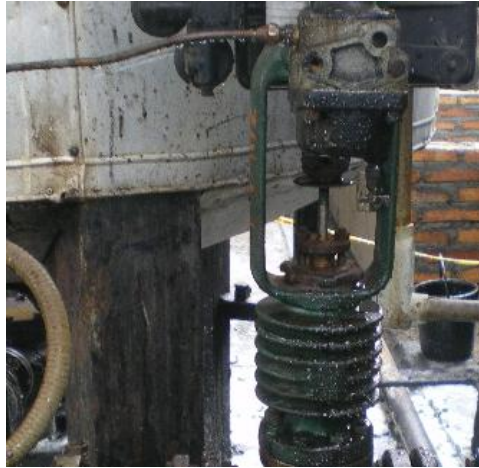
Figura 44. Indicador de apertura de la válvula. Fuente: Autor
