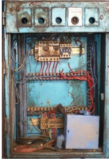
Figura 46. Tablero de control de la caldera JCT-2 Fuente: Autor
