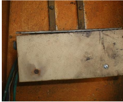
Figura 50. Caja de control electrónico del tanque. Fuente: Autor
