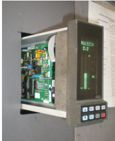
Figura 5. Controlador digital de válvula para el paso de emulsificante.
