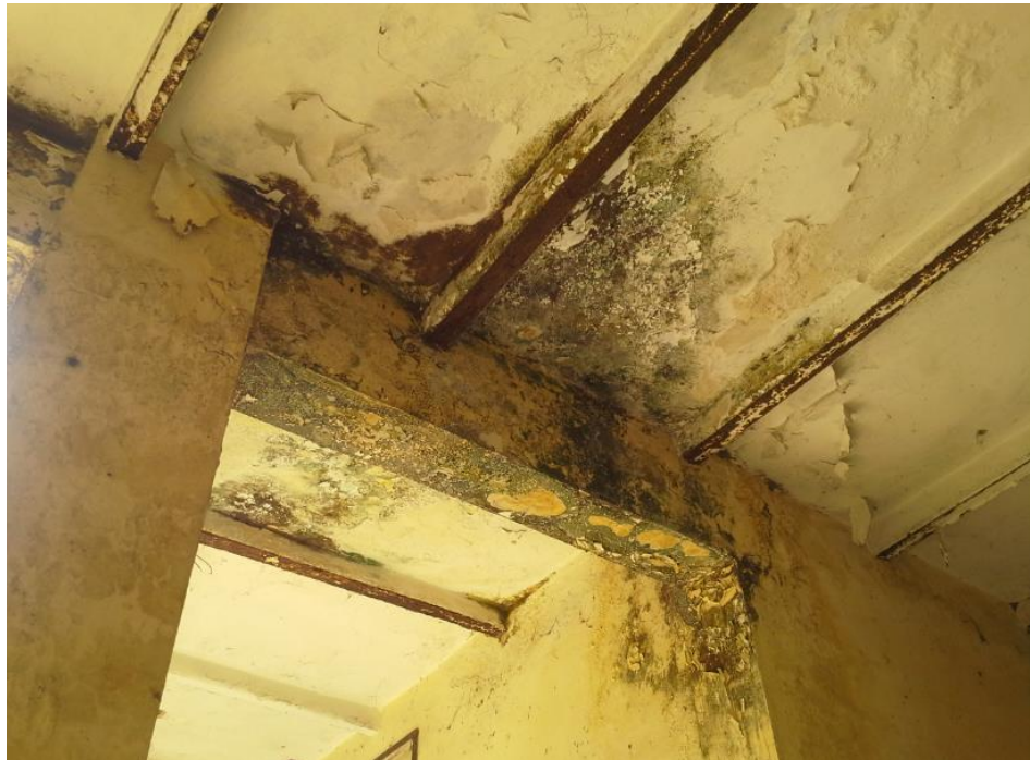
Ilustración 25: Viguetas bajo placa segundo piso en avanzado estado de oxidación y corrosión (Autor).
