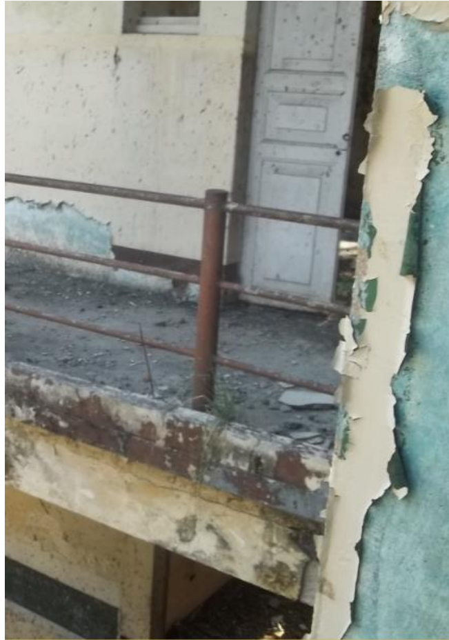
Ilustración 15: Desperdicio de capa de pintura sobre una columna (Autor).
