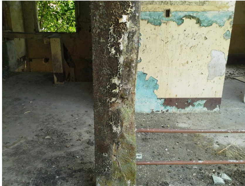
Ilustración 10: Lesion por esosion el columna del segundo piso (Autor).
