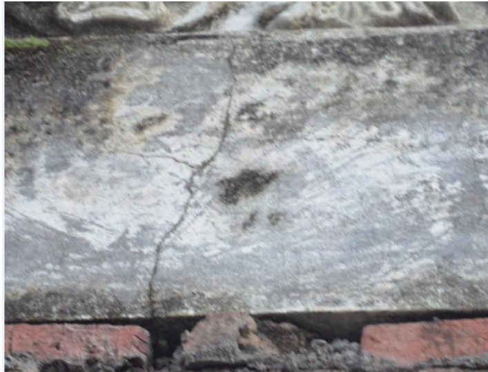
Ilustración 12: Flecha presente en dintel del segundo piso (Autor).
