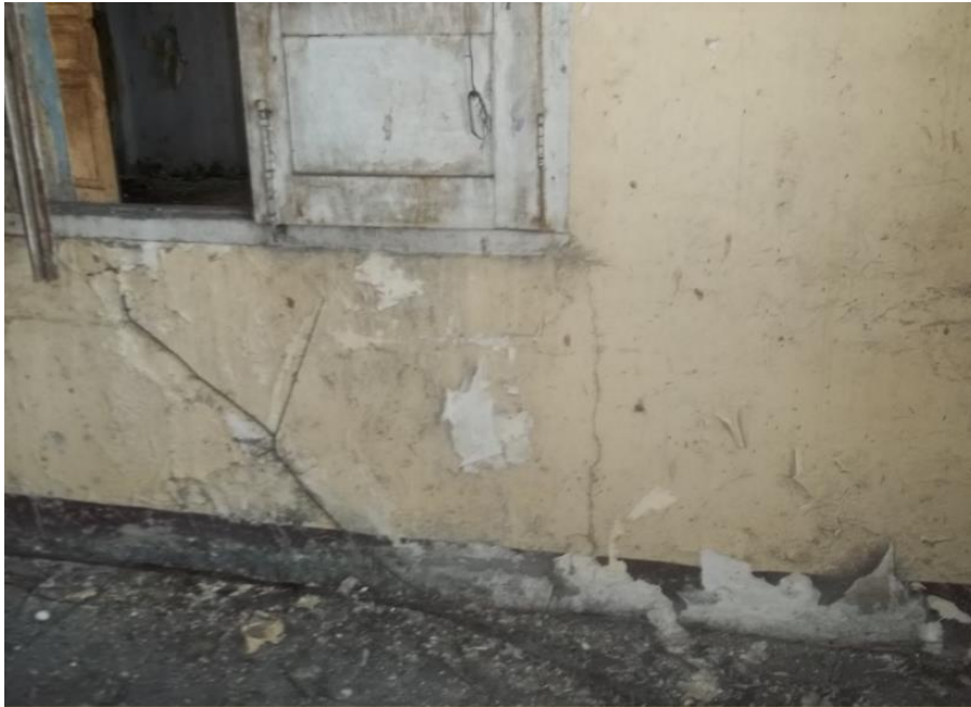
Ilustración 14: Fisura en el salon 9 del segundo nivel (Autor).
