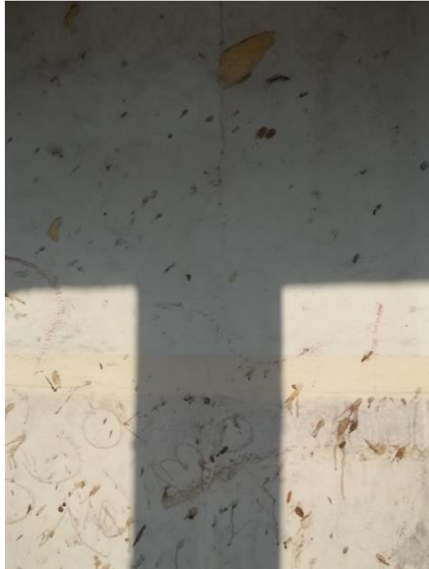
Ilustración 11: Eses de murcielago y palomas en la estructura (Autor).
