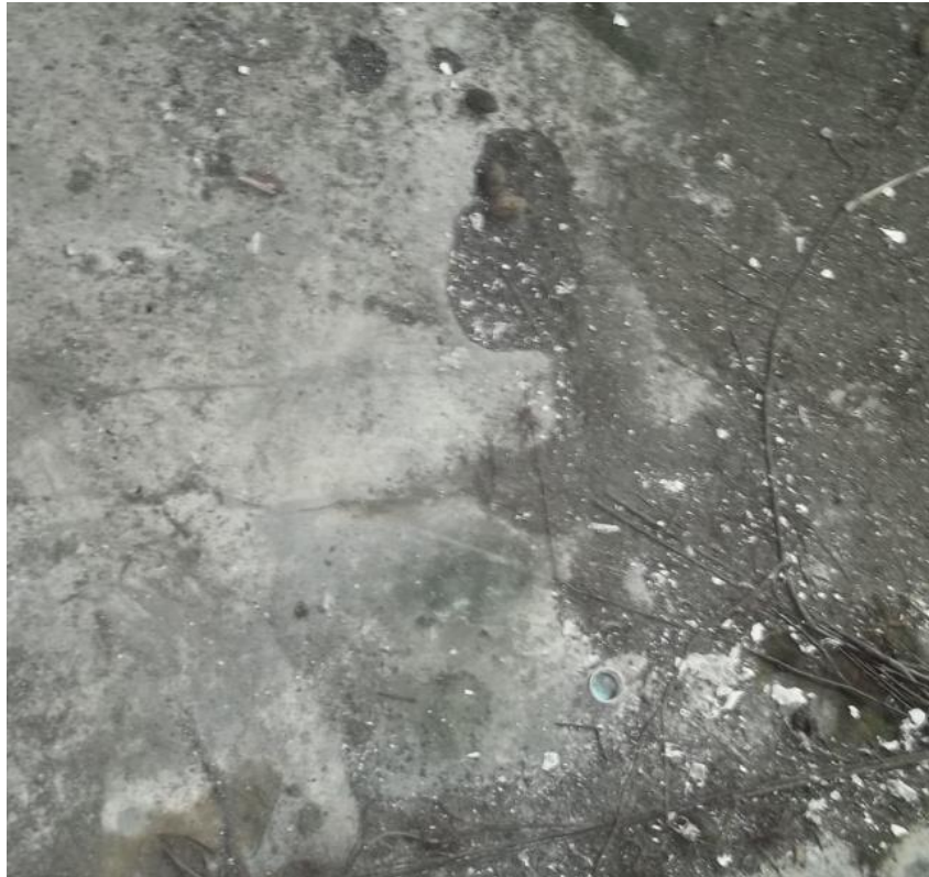
Ilustración 16: Erosion mecanica en la placa del primer nivel de la estructura (Autor).
