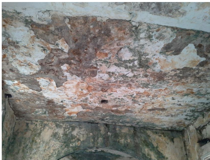
Ilustración 9: Humedad en techos y paredes de la estructura (Autor).
