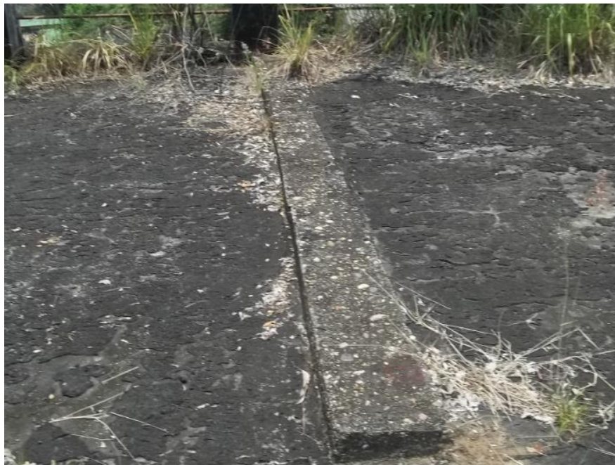
Ilustración 19: Erosion química en viga de cubierta (Autor).
