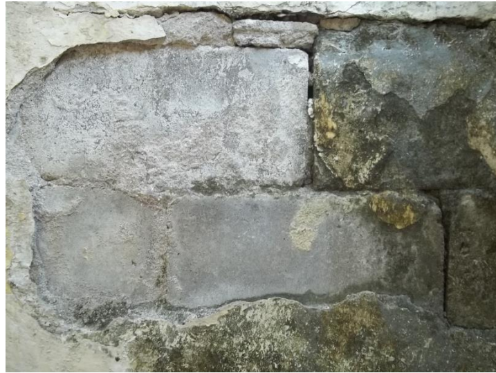
Ilustración 24: Erosion química de mortero de junta (Autor).
