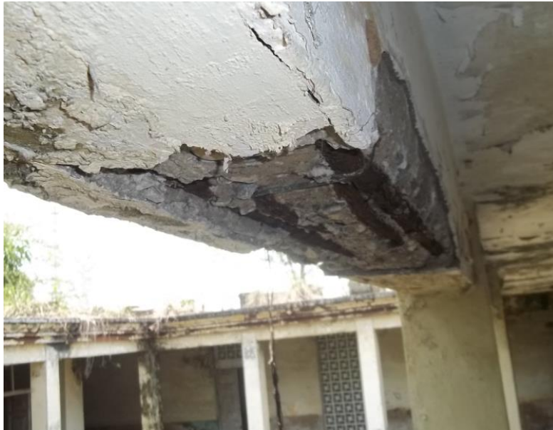
Ilustración 18: Oxidación y corrosión en el acero de refuerzo (Autor).
