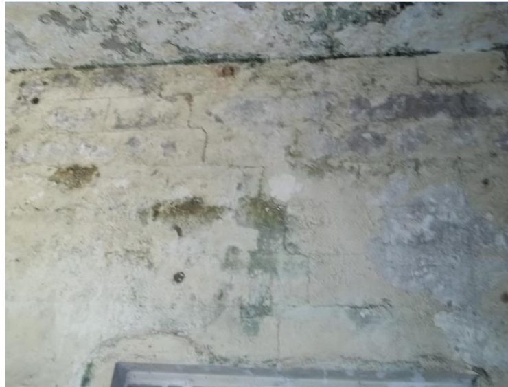
Ilustración 13: Grieta en muro divisorio (Autor).
