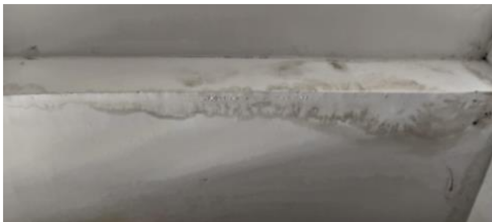
Figura 2. Presencia de humedad por condensación. Fuente: propia
