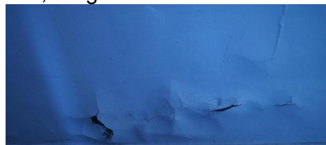
Figura 16. Erosión del pañete.
