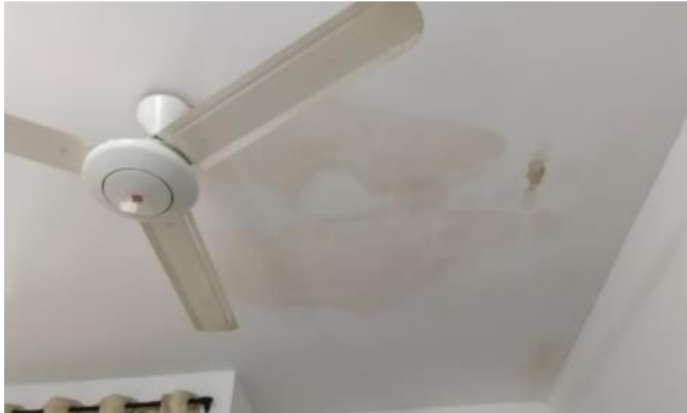
Figura 1. Presencia de humedad por filtración en cielo raso. Fuente: propia
