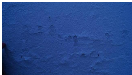
Figura 17. Desprendimiento de pintura y pañete.
