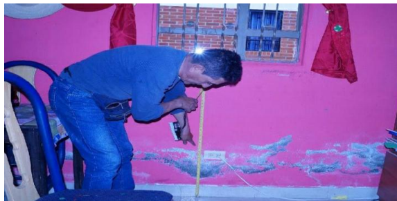
Figura 15. Toma de medida a lesiones evaluadas en muros de urbanización Guazuca.
