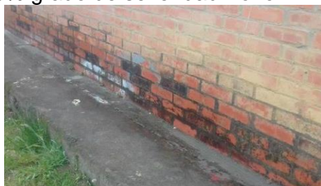
Figura 20. Observación de manchas negras posiblemente por la presencia de material orgánico.
