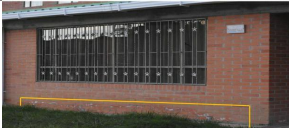
Figura 14. Presencia de humedad en muros de la urbanización Guazuca.
