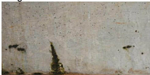
Figura 18. Presencia de humedad en muros de las casas de la urbanización Guazuca.
