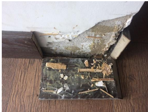
Figura 55. Adhesivo contaminado, guarda escoba.
