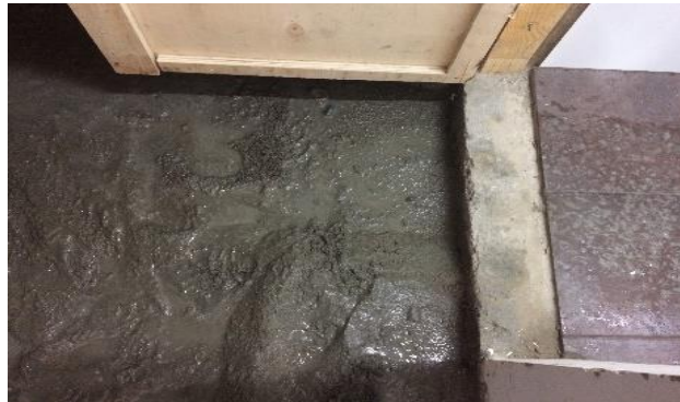
Figura 9. Empalme en baños.
