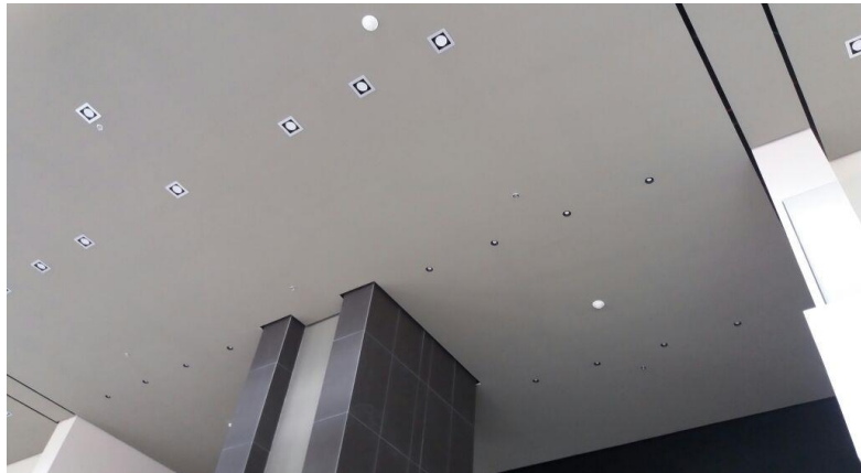
Figura 39. Detalle de luminarias
