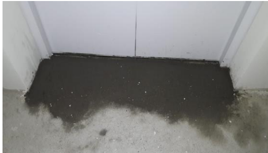
Figura 10. Empalme en ascensores
