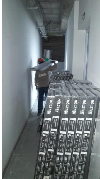
Figura 58. Almacenamiento de material.
