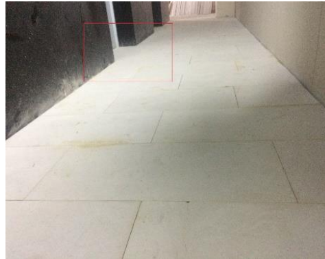
Figura 16. Detalle de cambio de medida de chazo en llegada a ascensor.
