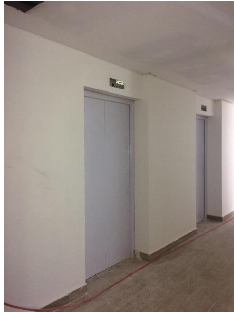
Figura 42. Registro fotográfico de mochetas en ascensor 1 y 2
