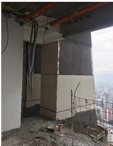
Figura 43. Revisión de calidad, dilataciones
