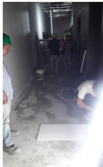
Figura 15. Detalle de modulación de chazos en llegadas a ascensor y montaje de baldosas.
