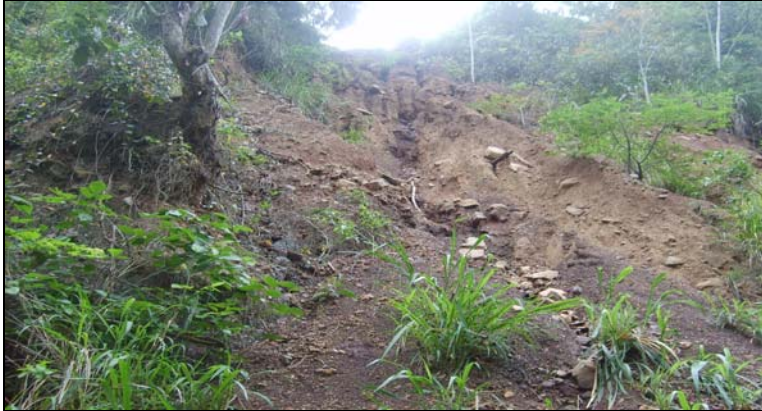
Figura 16. Erosión talud que conforma la cañada La Honda
