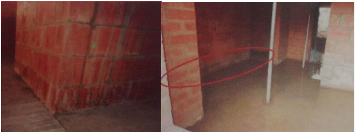
Figura 5. Humedad en las paredes
