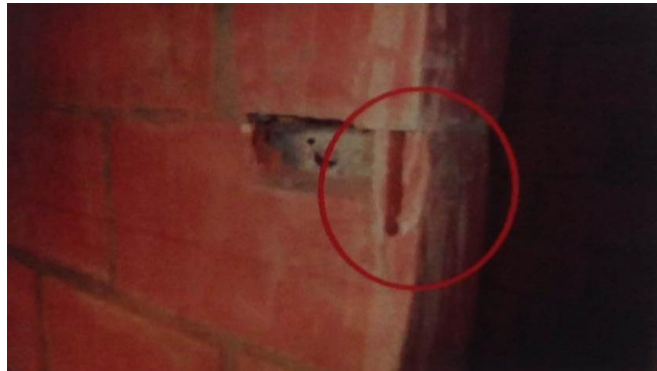
Figura 4. inconvenientes muros de mamposteria
