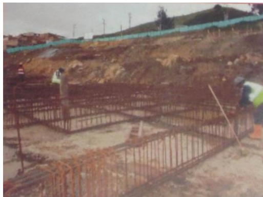
Figura 3. Inconvenientes con la cimentación
