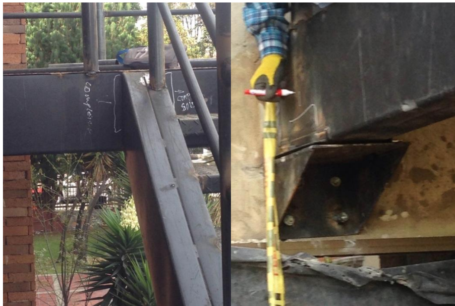
Figura 24. Detalles por el inspector en donde se evidencia la falta del cordón de soldadura
