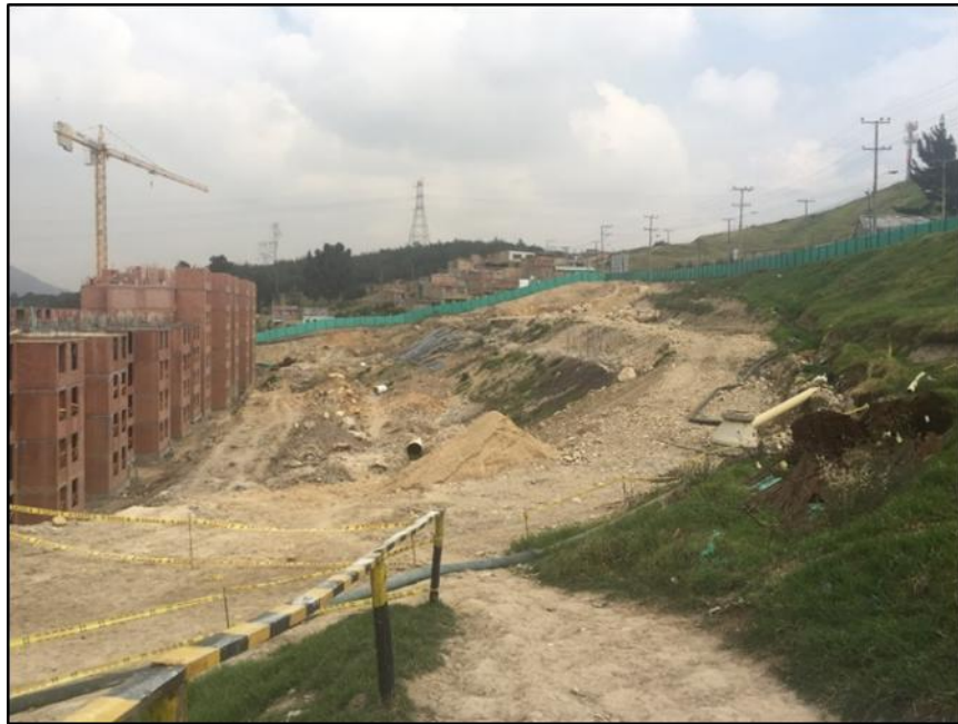
Figura 12. Torres P y O con problema con la elaboración del talud.
