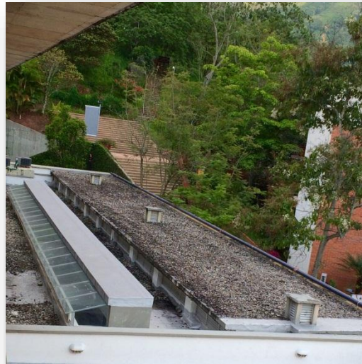
Imagen 8: Cubiertas con Materiales Reflectantes
