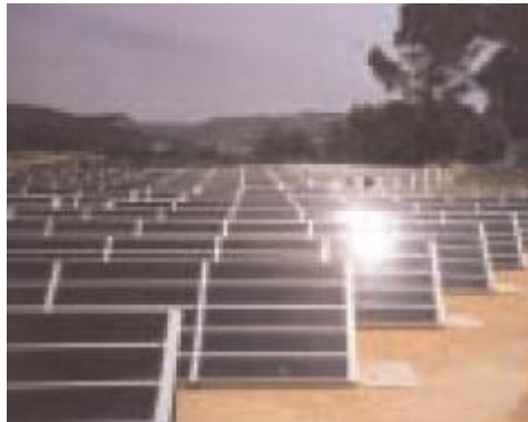
Imagen 34. Paneles solares en el balneario hervidero de cofrentes.
