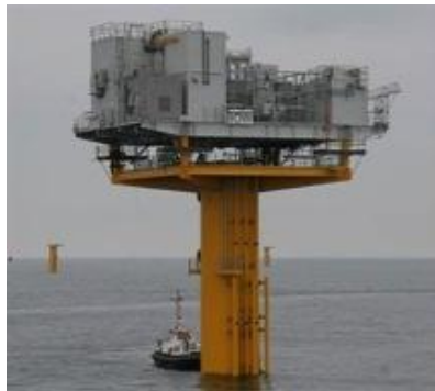
Figura 51. Plataforma de servicio eléctrico, recolector de la energía producida por los aerogeneradores.
