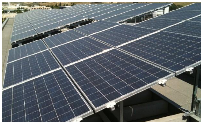
Imagen 43. Paneles solares instalados en colegio salesiano Bucaramanga.
