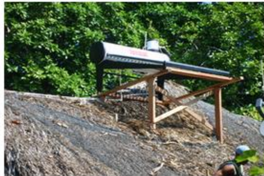
Calentador para suministro en habitacion de visitantes
