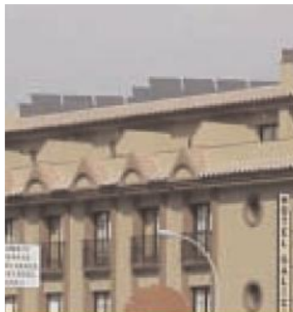
Imagen 35. Hotel Galicia en Sevilla, España. Paneles solares térmicos en la cubierta.
