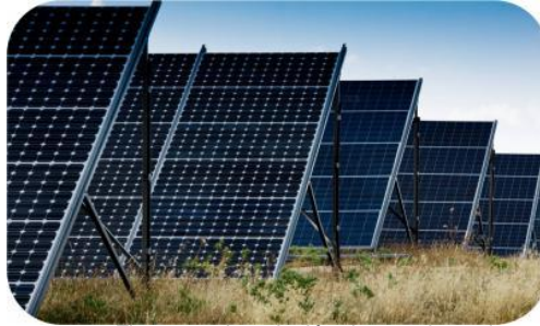
Figura 10. Instalación de paneles solares en suelo ubicados en Marche, Italia.
