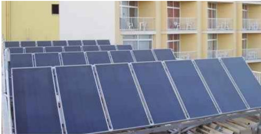
Imagen 33. Paneles solares en el techo del Hotel Amic horizonte.
