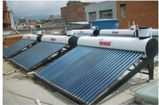
Suministro para el area de Hospitalizacion - 1800 L
