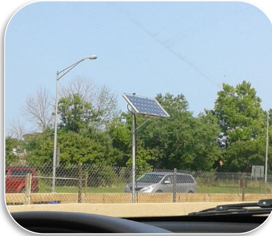
Figura 18. Paneles solares en carreteras principales de Chicago.
