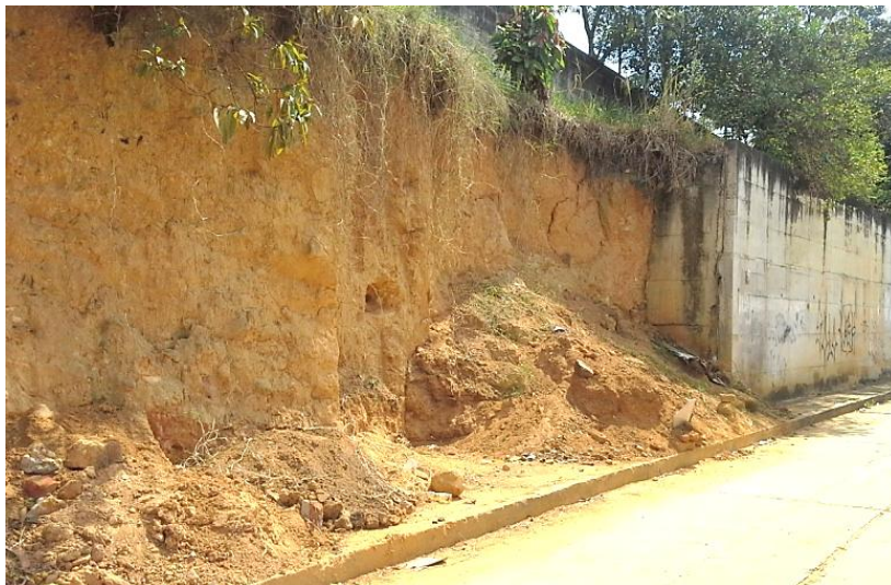
Fotografía 35. Erosión en talud y talud estabilizado con muro de contención.
