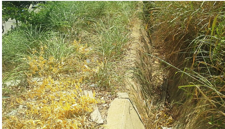
Fotografía 40. Evidencia de la falta de mantenimiento.
