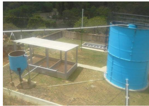
Fotografía 5. UASB y estructura de secado de lodos
