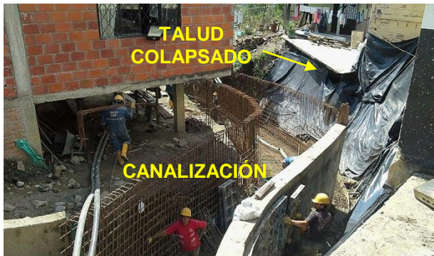
Fotografía 29. Vivienda afectada y canalización los Curos.
