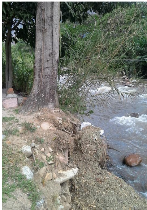
Fotografía 18. Acumulación de material pétreo y de arrastre.
