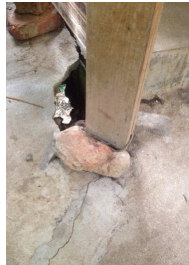
Fotografía 25. Baño en riesgo
