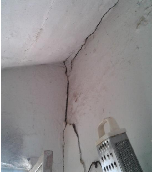
Fotografía 23. Grieta dentro de la casa.
