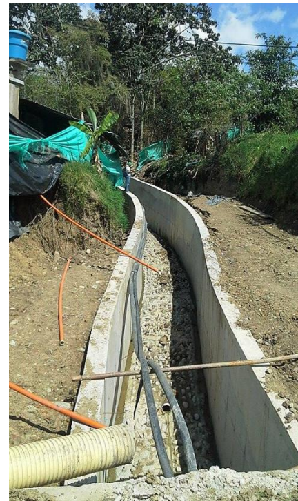
Fotografía 30. Canalización Quebrada los Curos.
