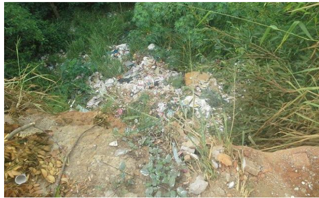
Fotografía 12. Erosión por acumulación de residuos
