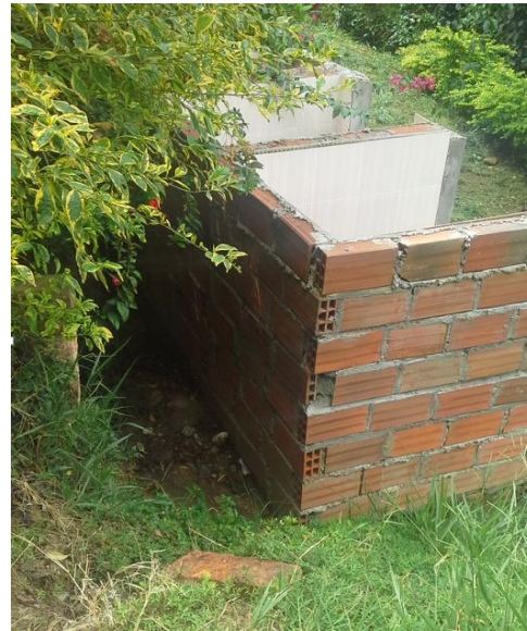
Fotografía 2. Saliente de agua bloqueado.
