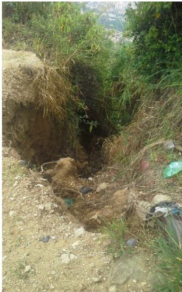
Fotografía 1. Desprendimiento de tierra.
