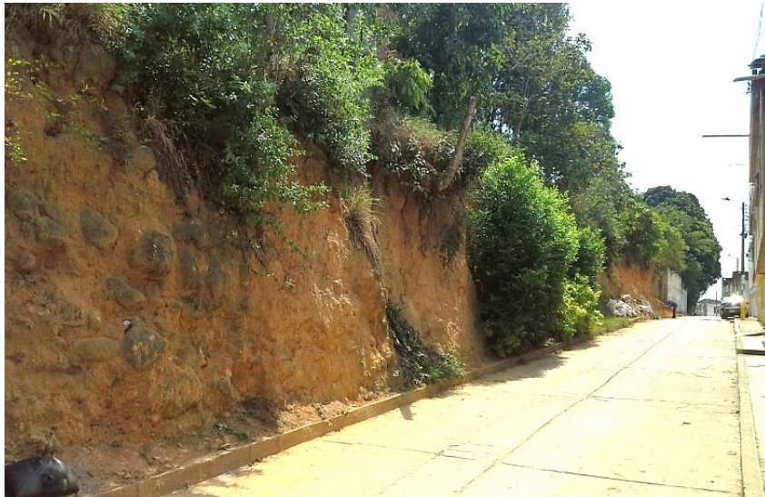
Fotografía 34. Talud sin estabilizar.
