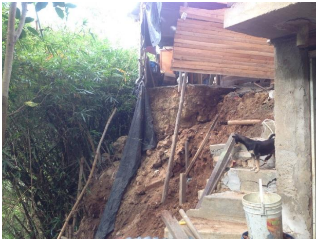
Fotografía 24. Parte del talud erosionado – Vivienda.
