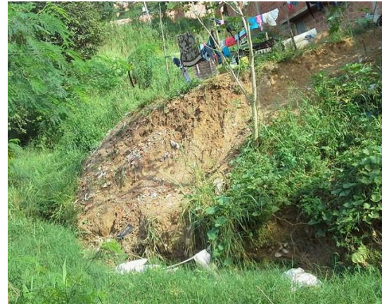
Fotografía 27. Socavación por cañada
