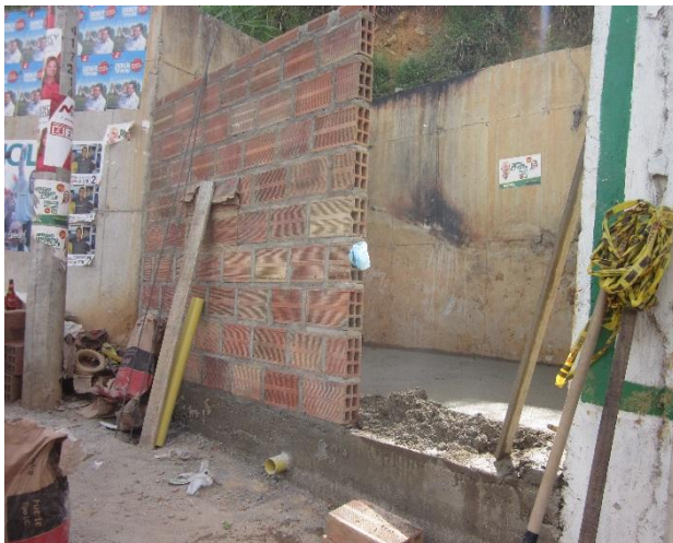
Fotografía 10. Construcción de caseta ilegal, utilizando las paredes del muro de contención.
