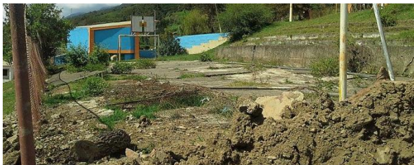
Fotografía 31. Cancha con problemas geotécnicos.
