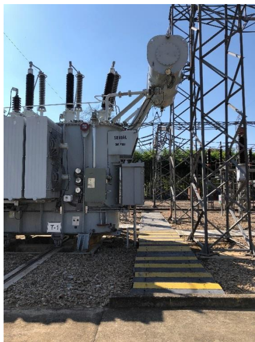
Figura 28. Transformador 1 Subestación Florida Fuente: Autor
