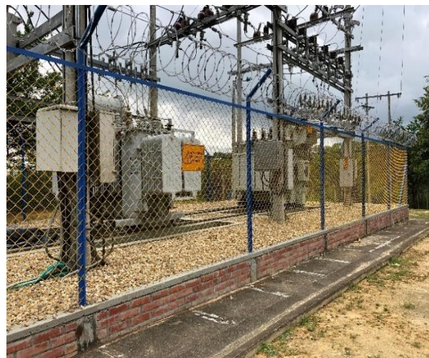
Figura 20. Malla eslabonada con concertina, subestación Lebrija.
