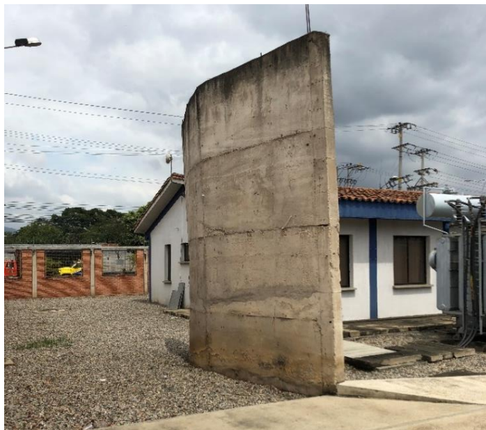
Figura 37. Muro cortafuego actual Subestación Caneyes.
