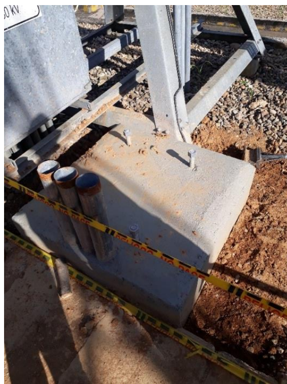
Figura 22. Base para interruptores Subestación Palos.
