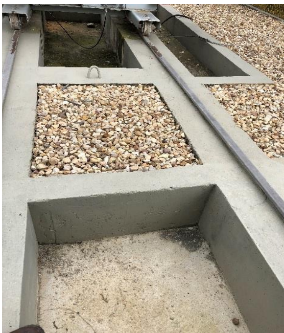
Figura 19. Foso para transformador, subestación Lebrija.
