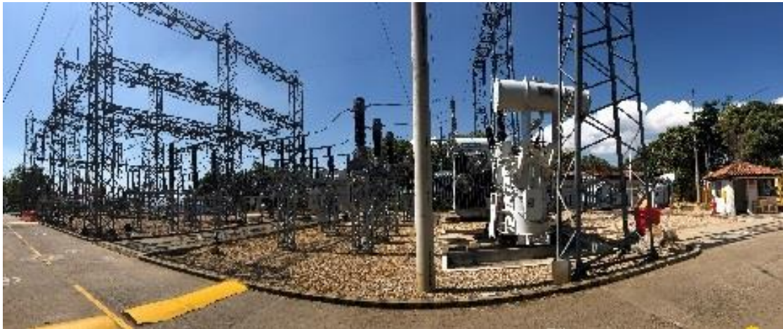
Figura 30. Transformador 2 Subestación Minas
