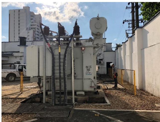
Figura 29. Transformador 3 Subestación Norte Fuente: Autor
