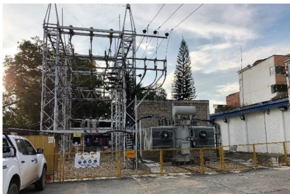
Figura 4. Subestación de la Subgerencia de Subestaciones y líneas.
