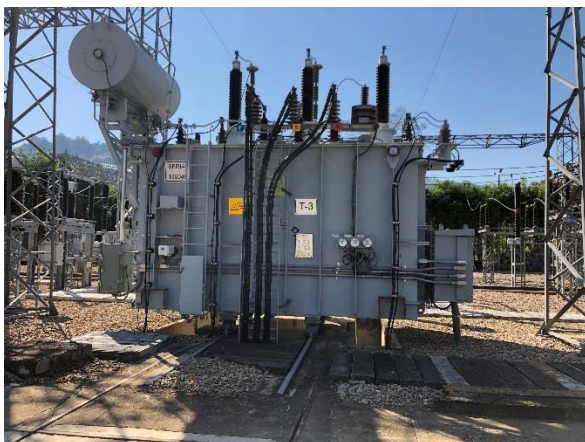
Figura 27. Transformador 3 Subestación Florida Fuente: Autor
