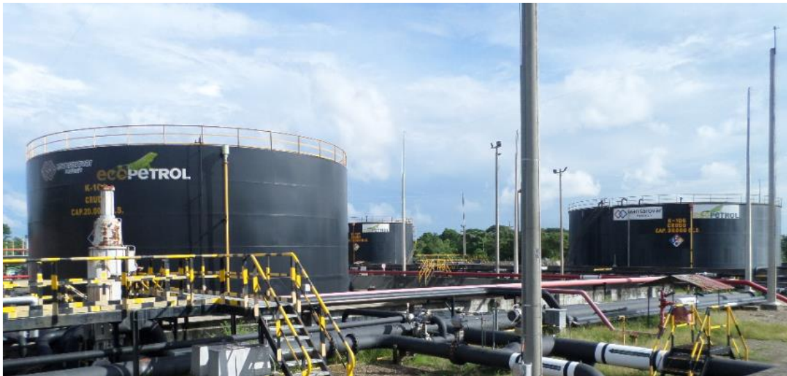
Figura 8. Tanques de almacenamiento Fuente: Tomado en el lugar de operación de la empresa
