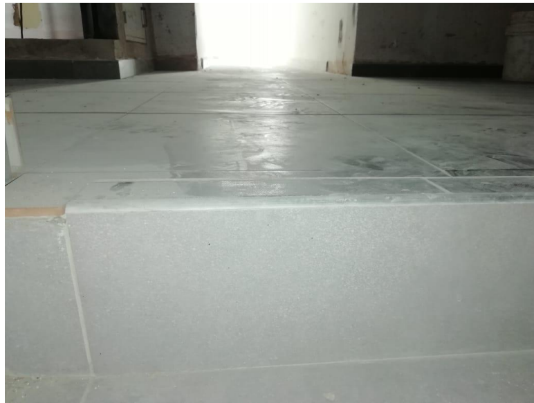
Figura 25. Brincos y tropiezos entre losas de enchape
