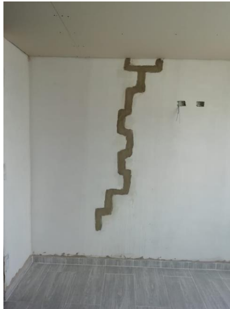
Figura 8. Fisuras presentadas en los muros
