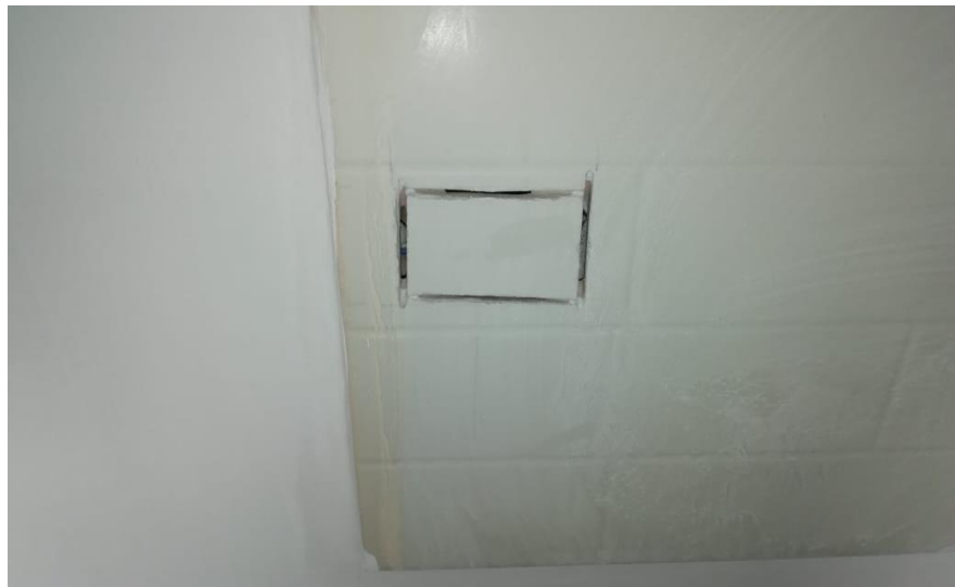
Figura 16. Losas de cerámica sin roturas correspondientes de acuerdo a las especificaciones
