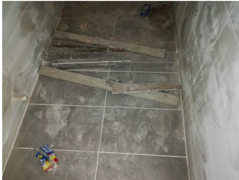
Figura 5. Pollos de la base de correderas de baño derribadas
