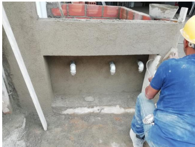
Figura 11. Caja de inspección tubería de gas
