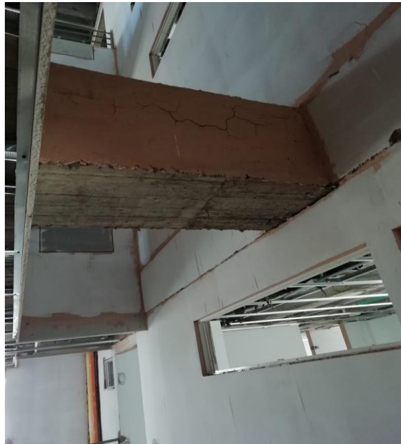
Figura 4. Dilataciones en el estuco de la viga
