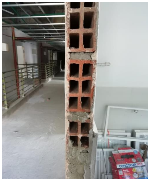
Figura 6. Muros internos sin frisar
