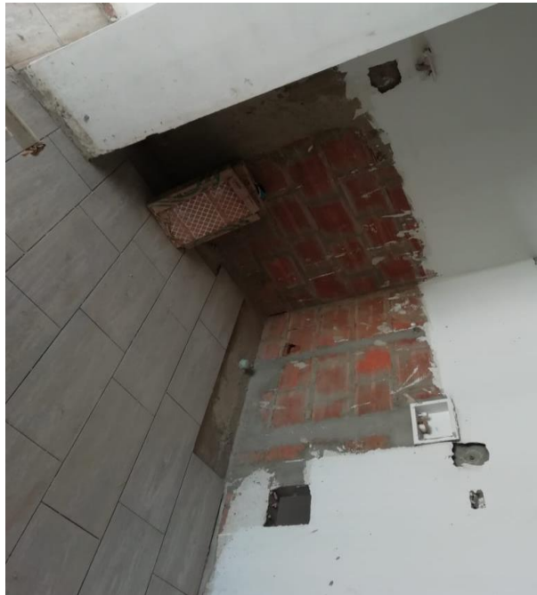
Figura 3. Detalle "falta de enchape de muro y terminados en enchape de piso"
