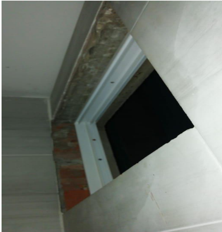
Figura 21. Secciones con faltantes de losas de enchape
