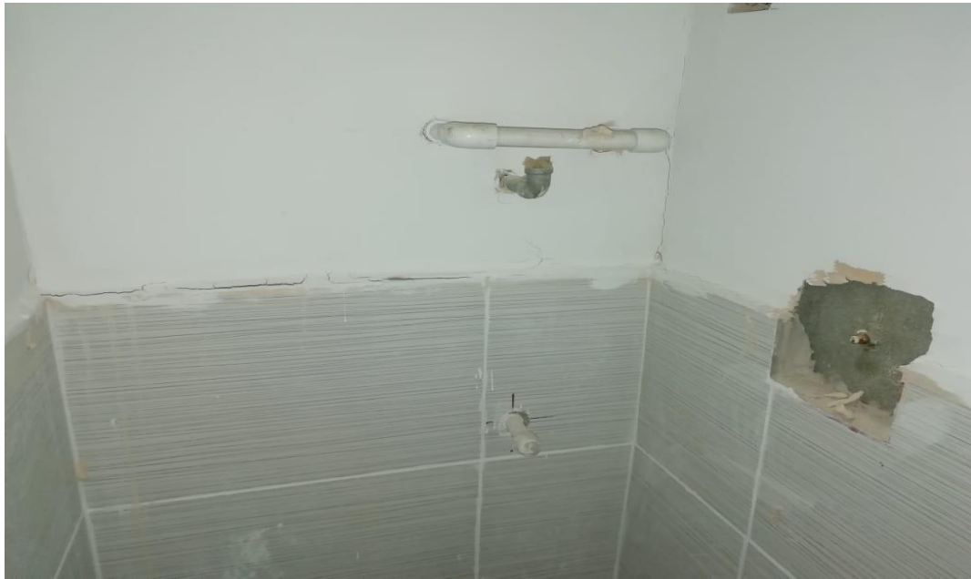
Figura 13. Enchape sin limpieza final
