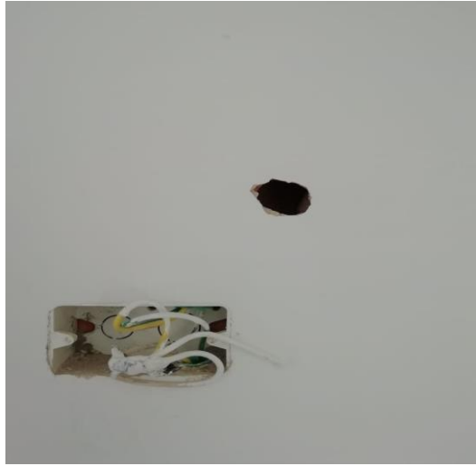
Figura 10. Huecos en muros
