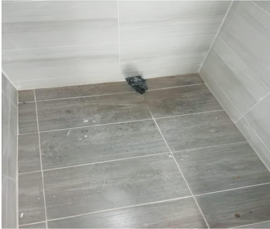
Figura 15. Losas de cerámica con manchas
