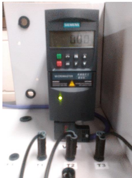
Figura 5. Micromaster 440 instalado en el módulo de posición o velocidad.
