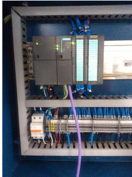
Figura 6. PLC S7-300 instalado en el módulo de posición o velocidad
