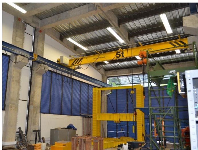
Figura 22. Puente grúa, Laboratorio de estructuras.
