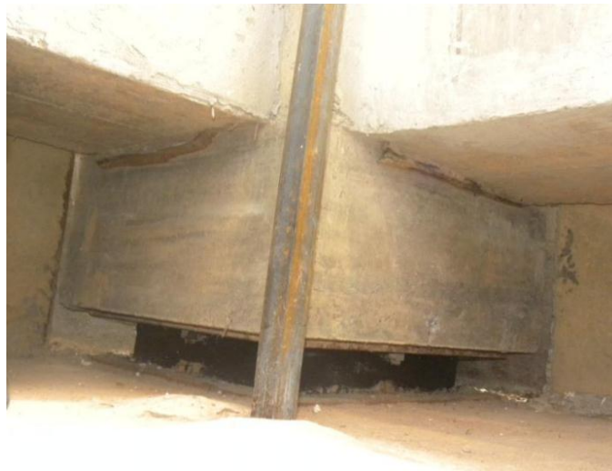
Figura 31. Aislador de neopreno en la base del pórtico.
