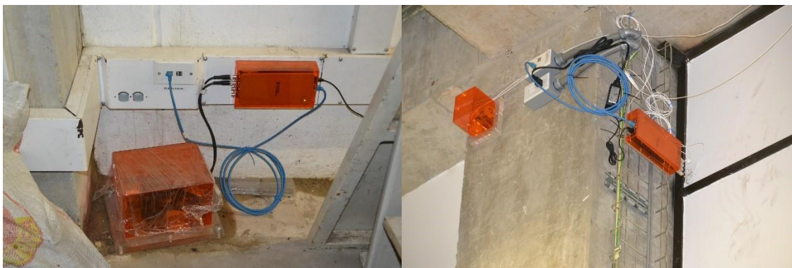
Figura 14. Equipo de adquisición instalado en el laboratorio de estructuras.
