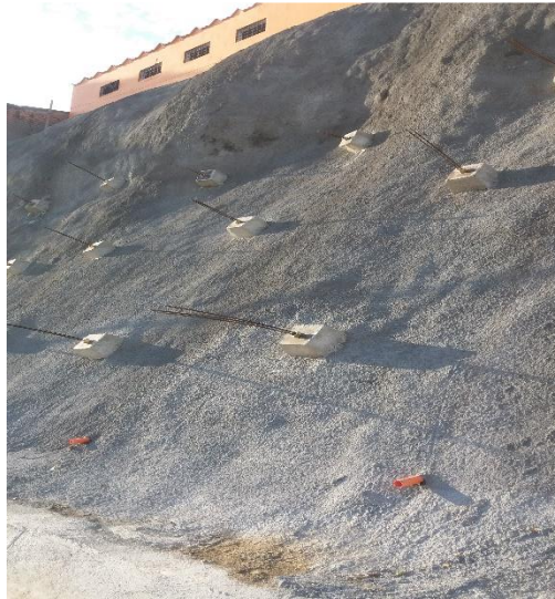
Fig.87 Drenes Fuente: autor
