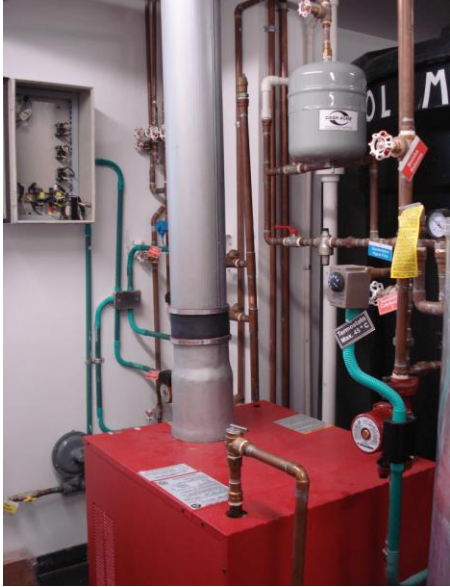
Figura 64 sistema completo calefacción por caldera
