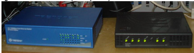
Figura 125 Red de datos (montaje final)
