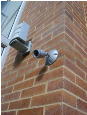
Figura 117 Circuito cerrado de televisión (montaje final)
