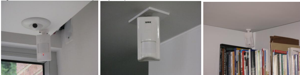
Figura 116 Sensores de movimiento (montaje final)
