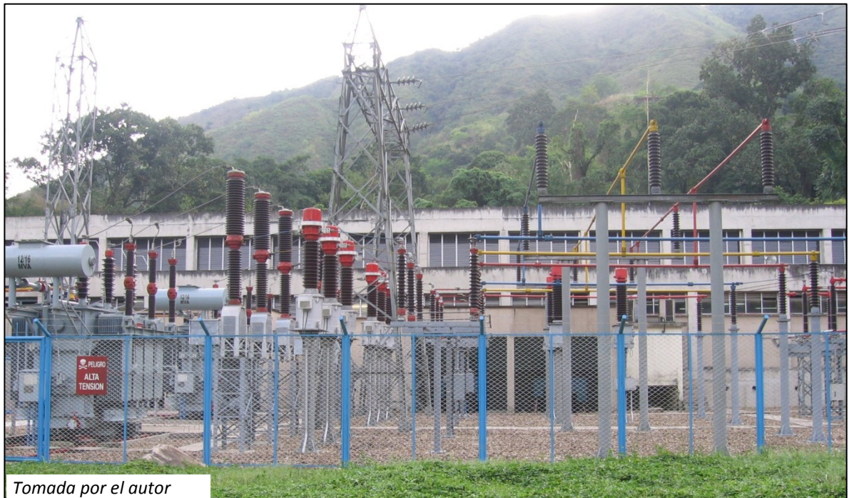
Figura 1. Subestación eléctrica de la planta Bosconia
