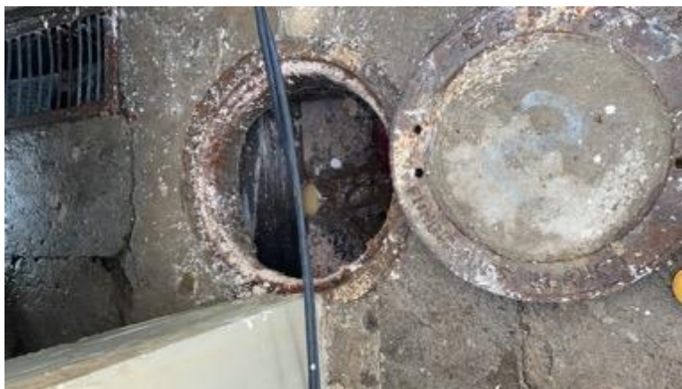
Ilustración 11: Pozo destapado. Fuente: Autor.
