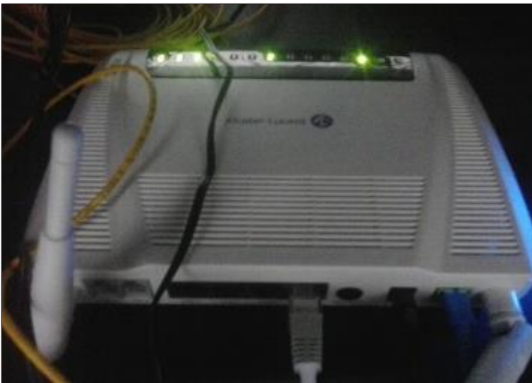
Figura 22. Revisión del router del proveedor principal de la red de internet del municipio de Barrancabermeja.
