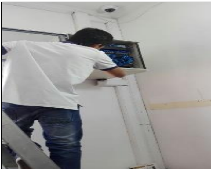
Figura 20. Revisión del switch del bunker de la alcaldía del municipio de Barrancabermeja
