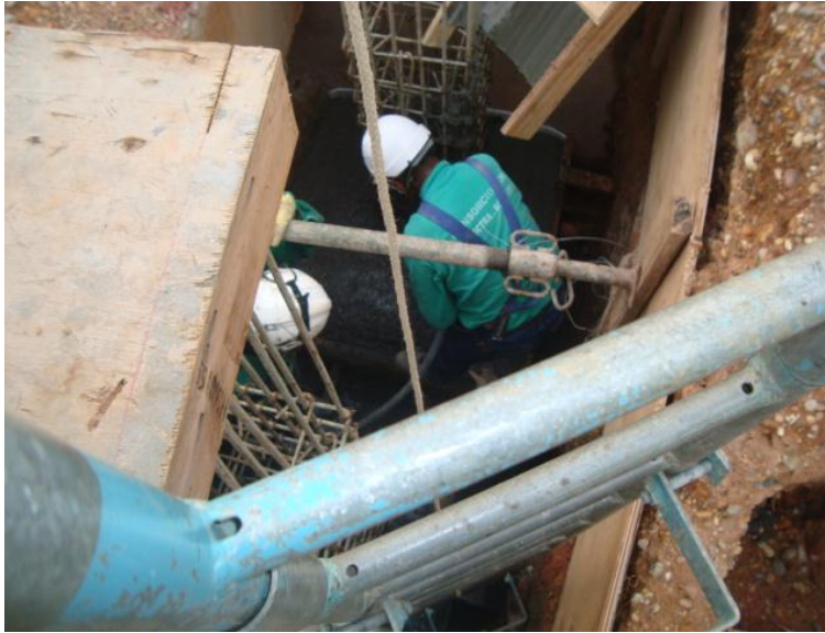
Imagen 16. Armado hierro para la base y pedestal, formateado base y fundida de la base
