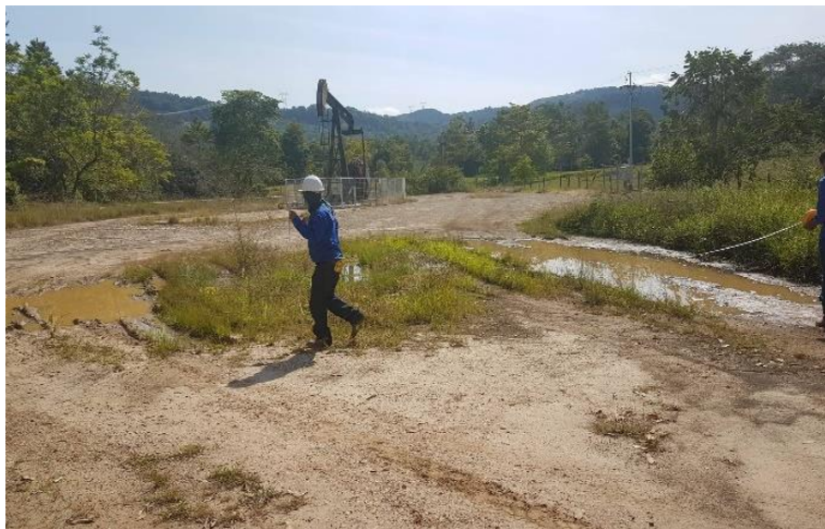
Imagen 15 Fallo presente en locación
