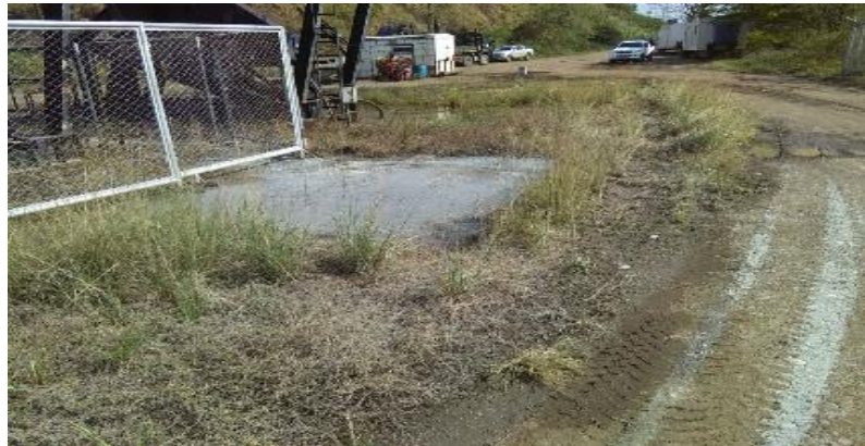
Imagen 19 Inspección previa en zona de fallo, locación Nutria
