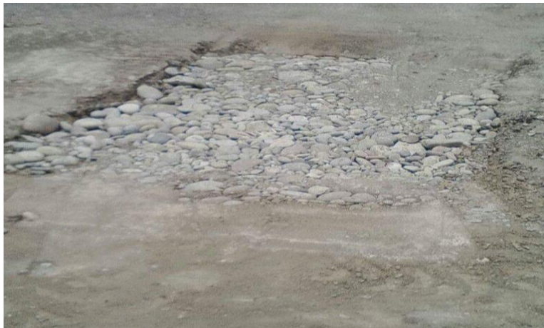
Imagen 24 Crudo de río compactado a máquina en zona de fallo
