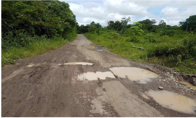
Imagen 16 Fallo presente en vía
