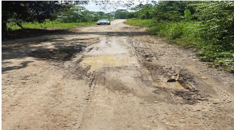
Imagen 17 Fallo presente en vía
