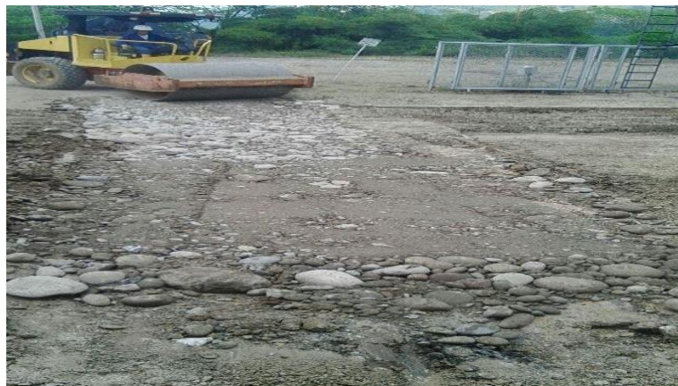
Imagen 25 Crudo de rio compactado a máquina en zona de fallo
