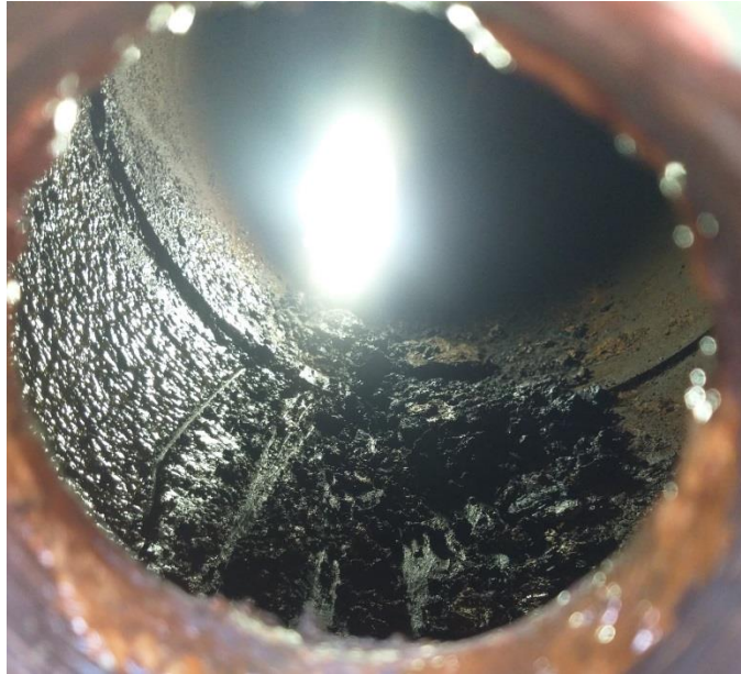
Figura 19. Interior del tanque del compresor M046 con residuos.
