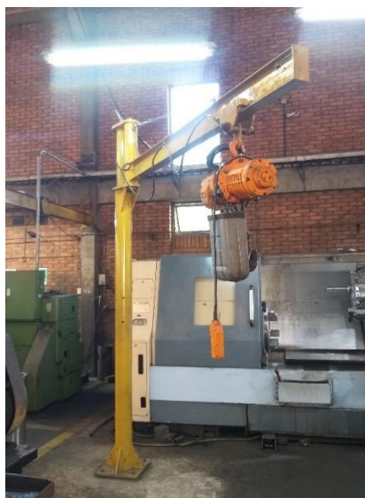
Figura 32. Grúa con diferencial eléctrico F089 instalada frente a CNC M059.
