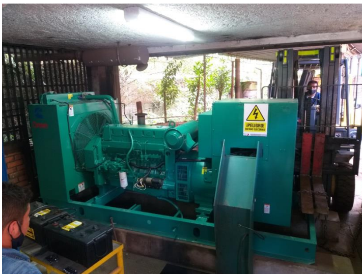
Figura 28. Ubicación del generador eléctrico Cummis de Industrias Lavco SAS.
