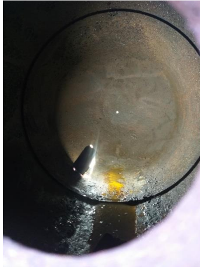
Figura 21. Interior del tanque del compresor M046 en buenas condiciones.
