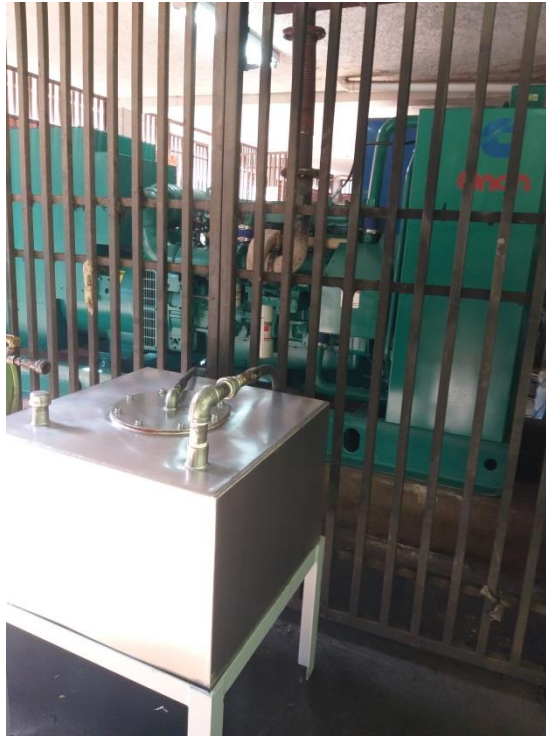
Figura 30. Tanque de acero inoxidable para ACPM, instalado para generador eléctrico Cummins.
