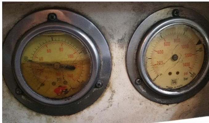
Figura 11. Manómetros deteriorados CNC M058.
