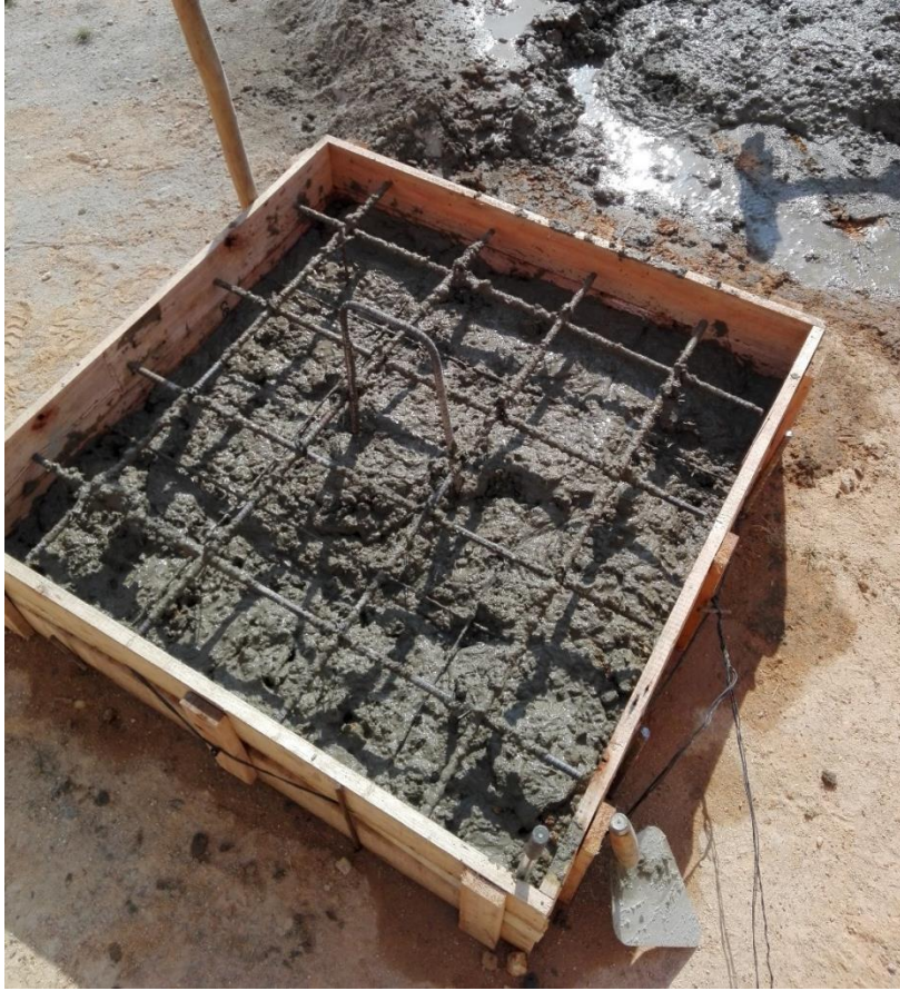
Figura 32 – Construcción de placa para impacto
