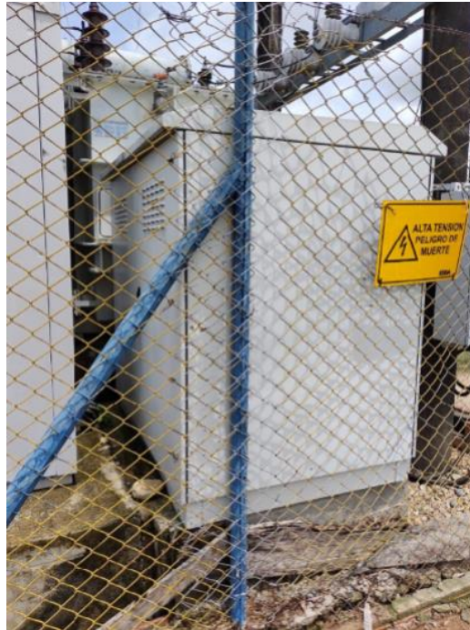
Figura 37. Adecuación malla eslabonada SE San Rafael
