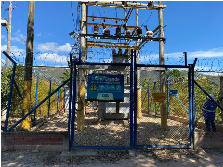
Figura 13. Subestación Llano Grande
