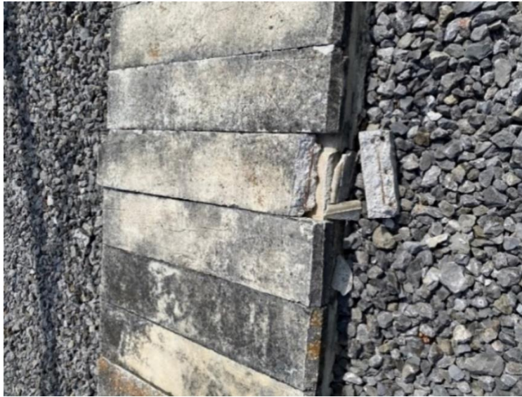
Figura 40. Tapa de cárcamo en mal estado
