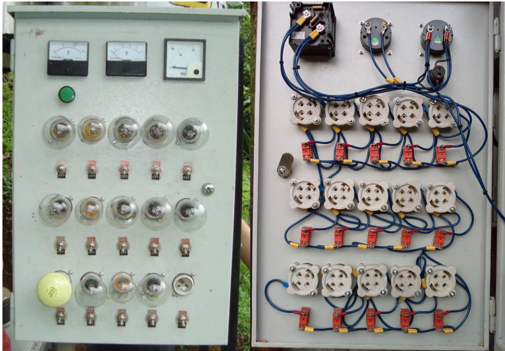
Figura 26 Panel de carga Fuente Autor del proyecto
