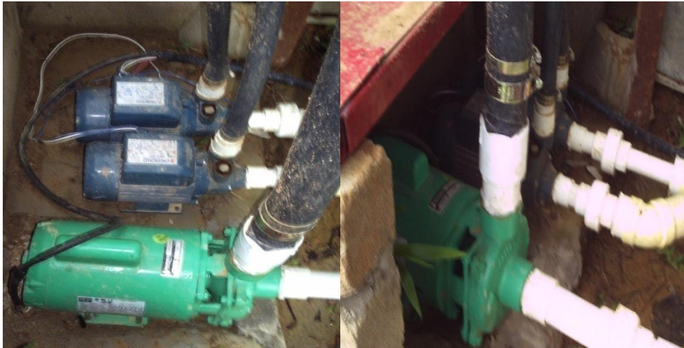
Figura 33 Bombas Fuente Autor del proyecto
