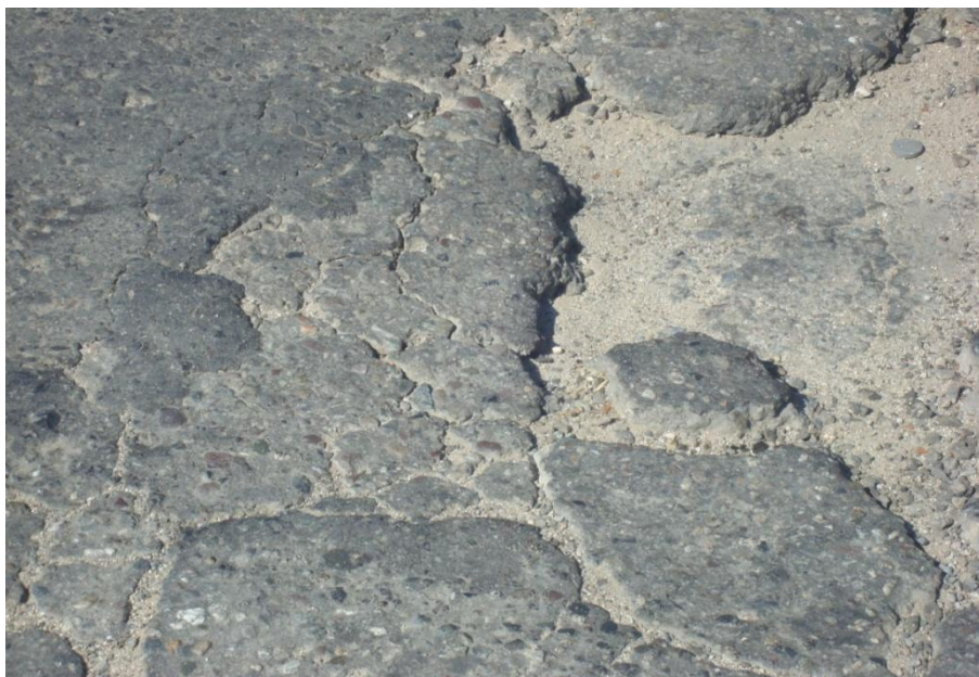
Figura 60. Sentido Café Madrid-Palenque Km 10+200, pavimento en mal estado
