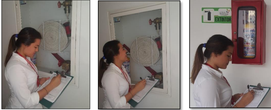
Figura 9. Verificación de elementos en gabinete tipo III Fuente. Autor
