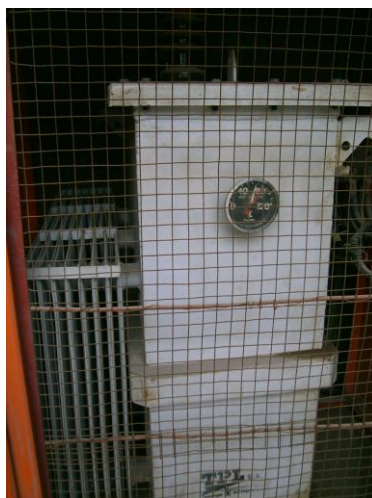
Figura 15. Distancias inexistentes de seguridad.
