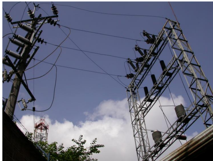
Figura 18. Acometida aérea. Llegada de alimentación a 44000V
