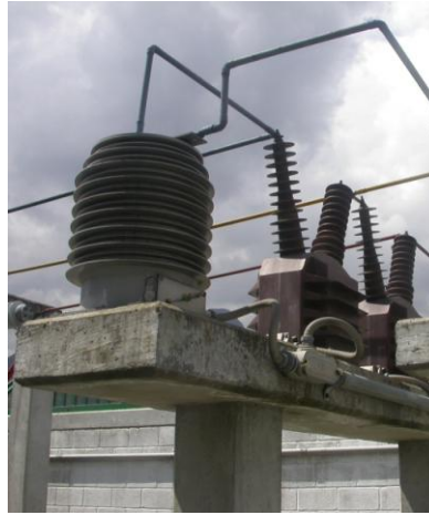
Figura 3. Transformadores de tensión y de corriente
