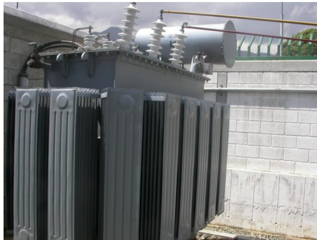
Figura 8. Transformador de potencia aislado en aceite.
