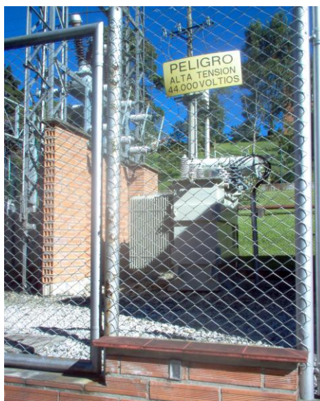
Figura 13. Señalización incorrecta de riesgo eléctrico
