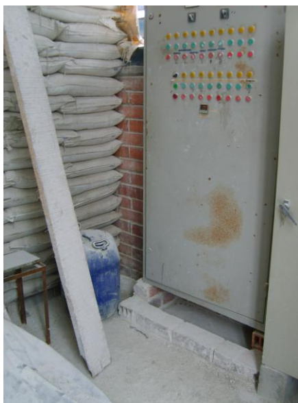
Figura 16. cuarto de control sin una malla de encerramiento apropiada
